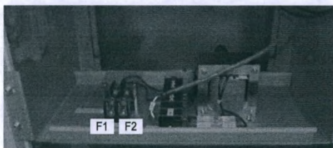
Рис. Силовой трансформатор (внутри шкафа управления потолочного опорного модуля С-дуги)
