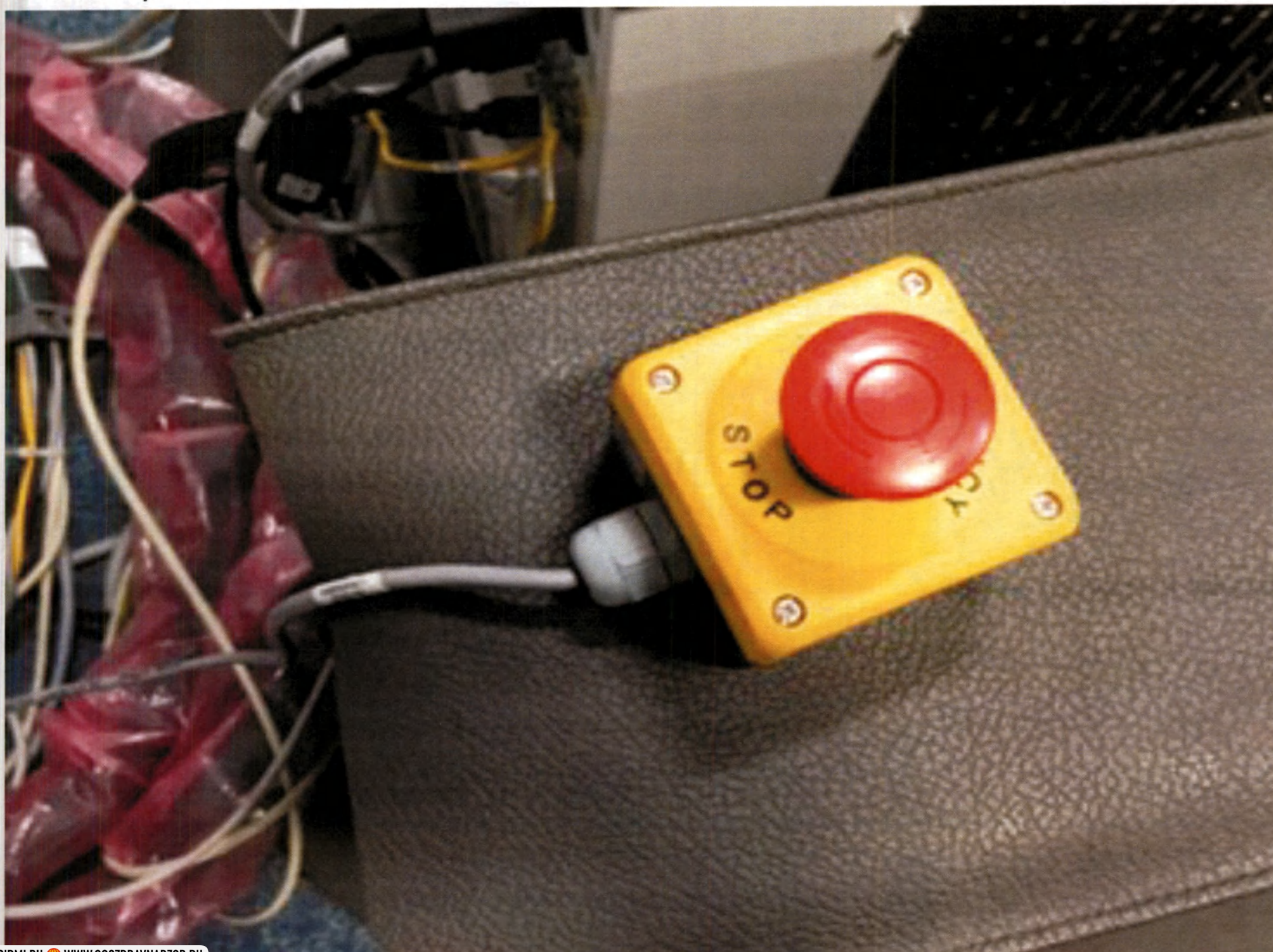
40. Кнопка аварийного выключения системы.
