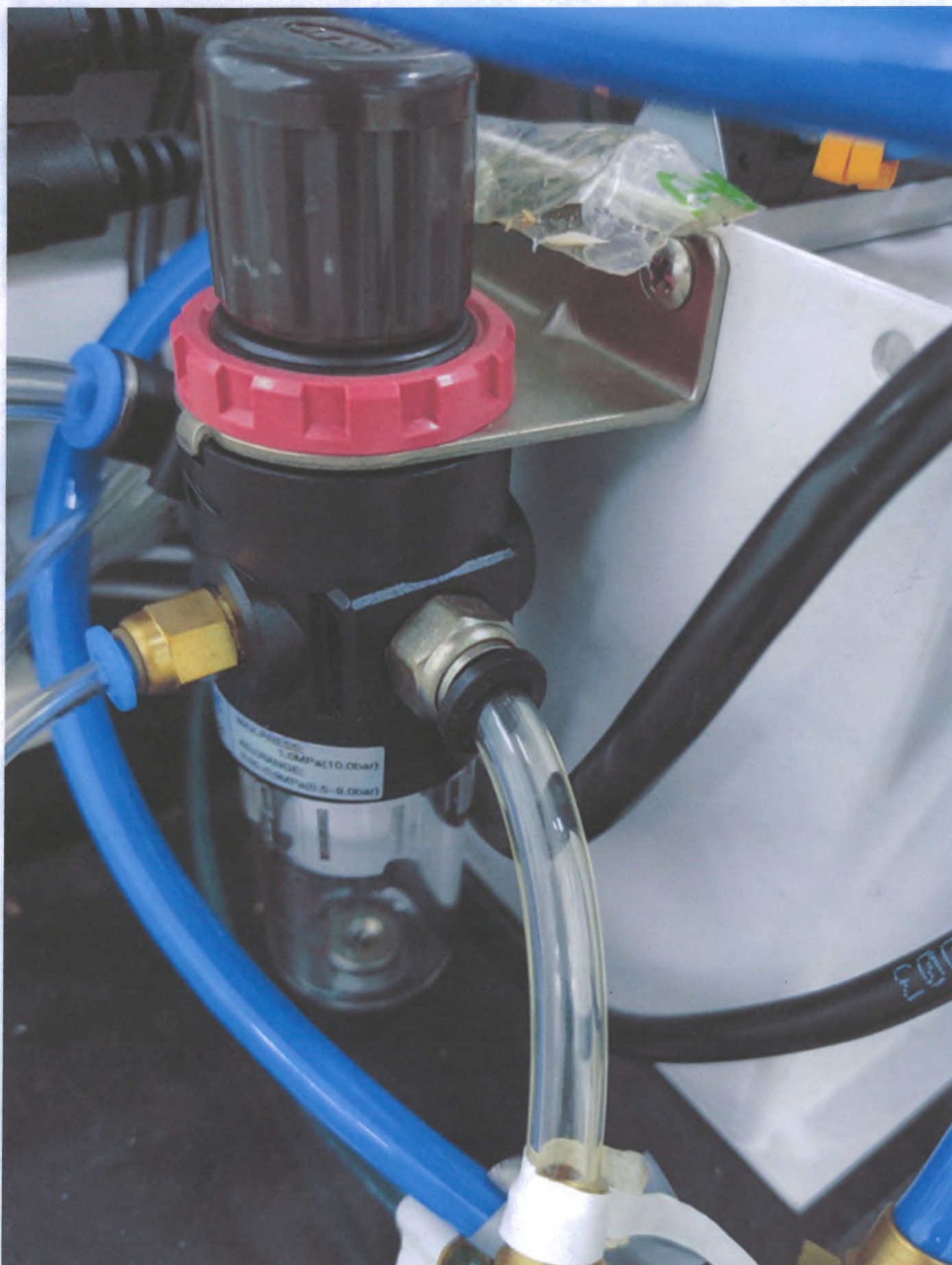
Фильтр воздушный 5 мкм
