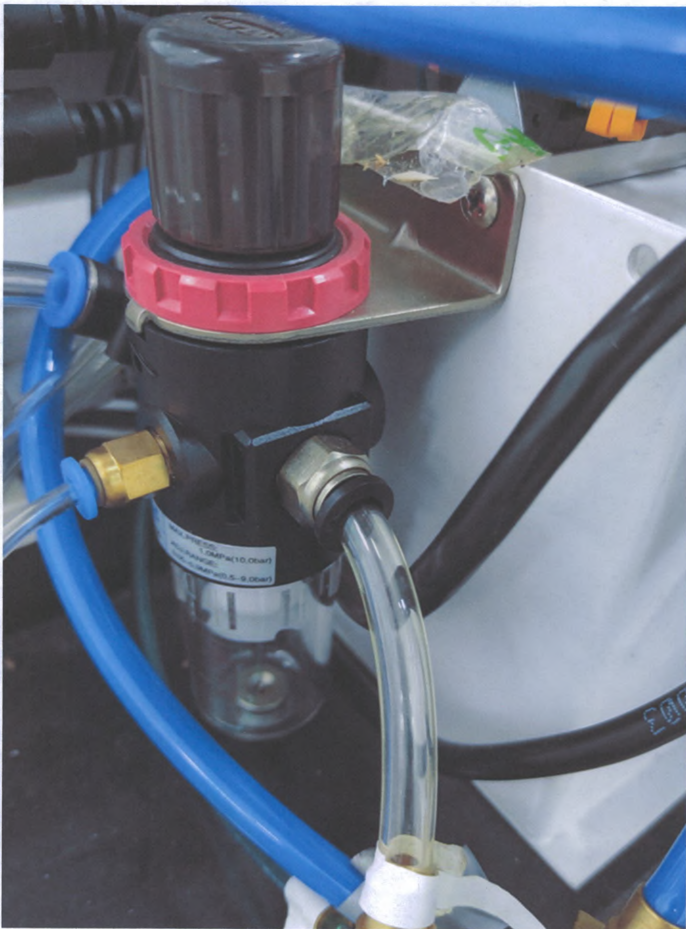
Фильтр воздушный 5 мкм
