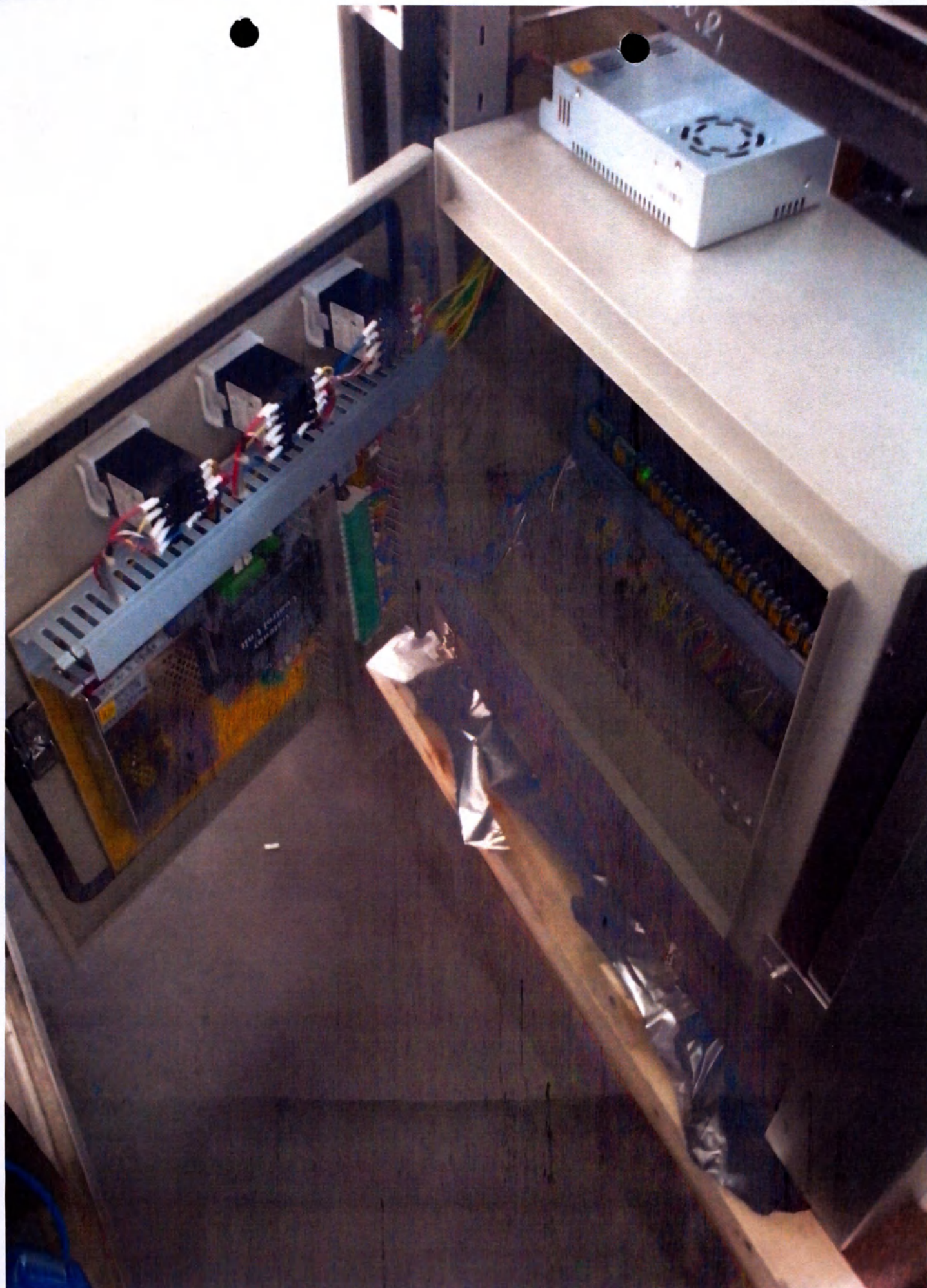
Электрическая распределительная коробка
