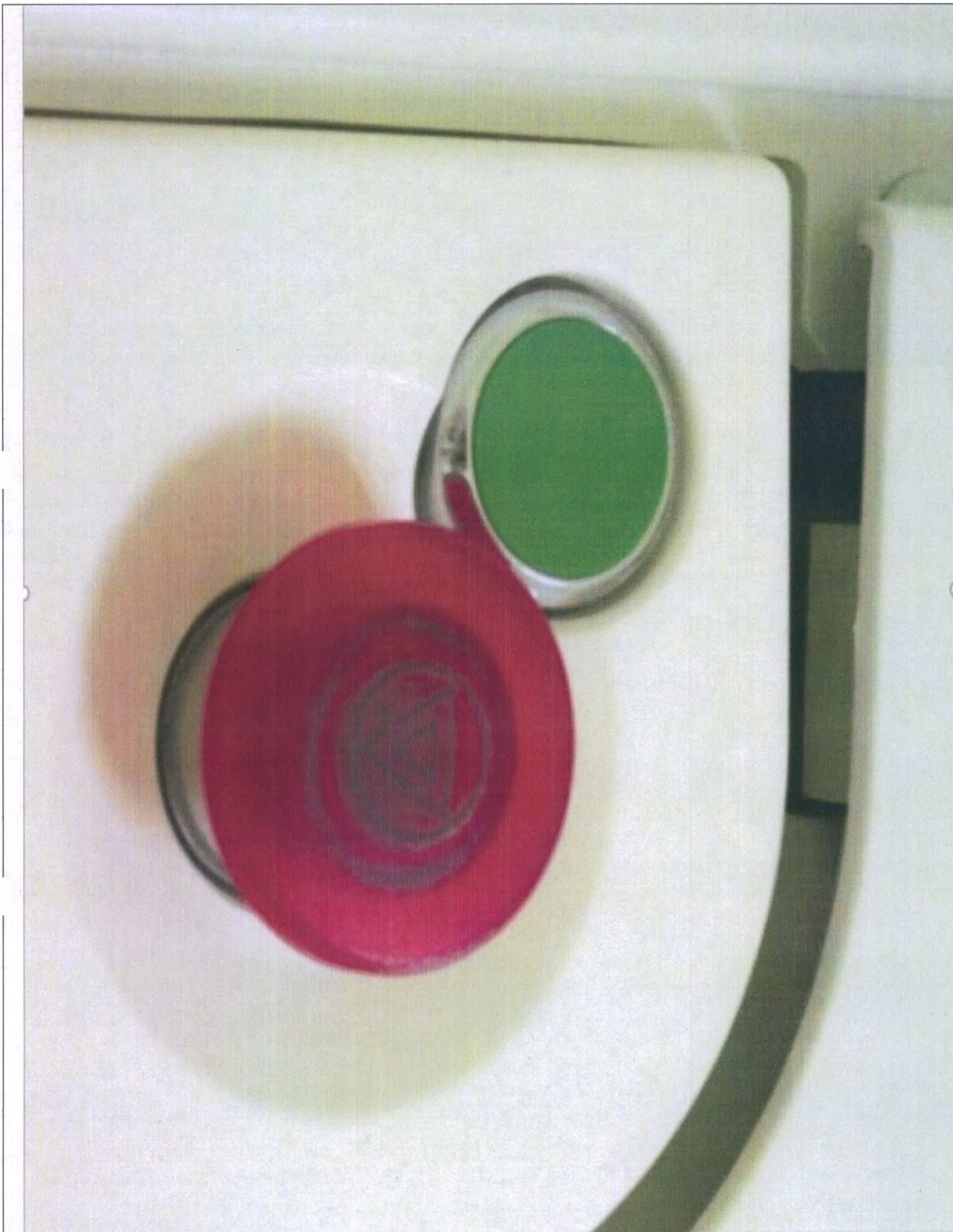
58. Рубильник аварийного выключения.
