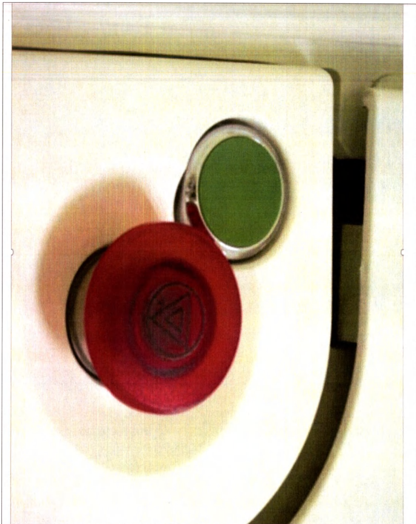
56. Рубильник аварийного выключения.
