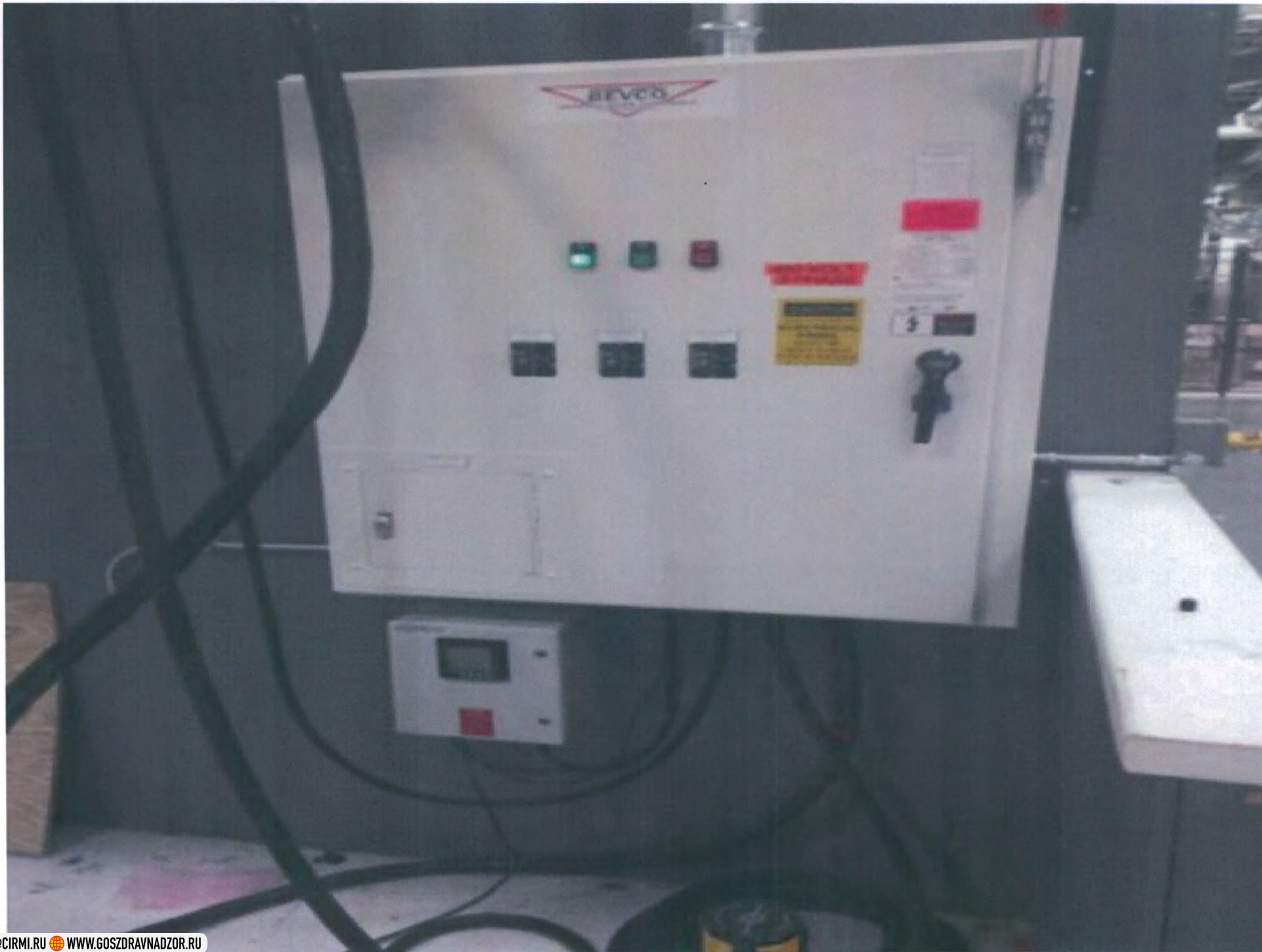
45. Щит силовой распределительный
