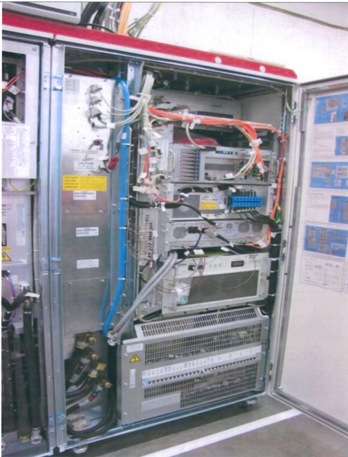
7. Шкафы с электронной аппаратурой для управления системами сбора данных томографа: - шкаф градиентов; - шкаф управления.
