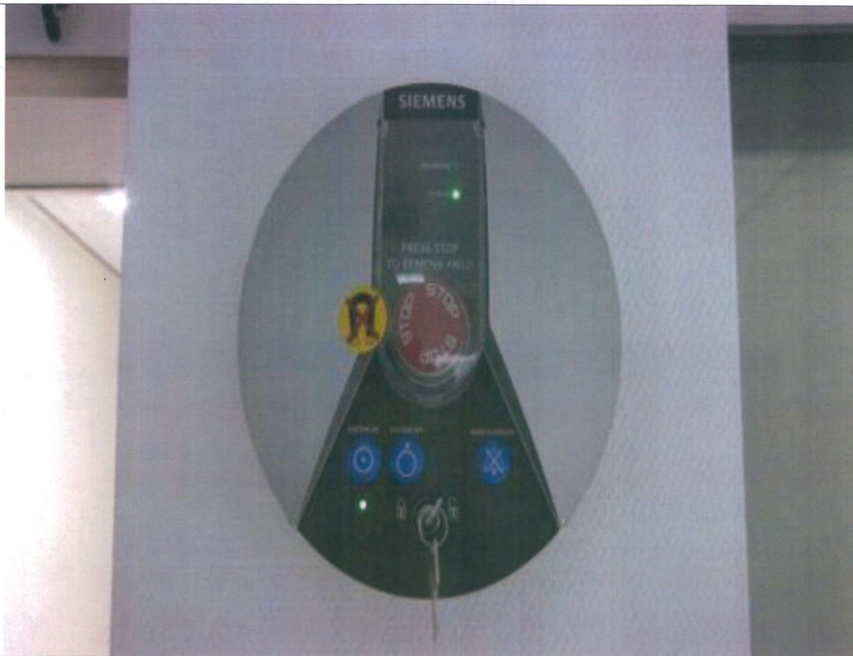
9.1 Блок аварийной сигнализации
