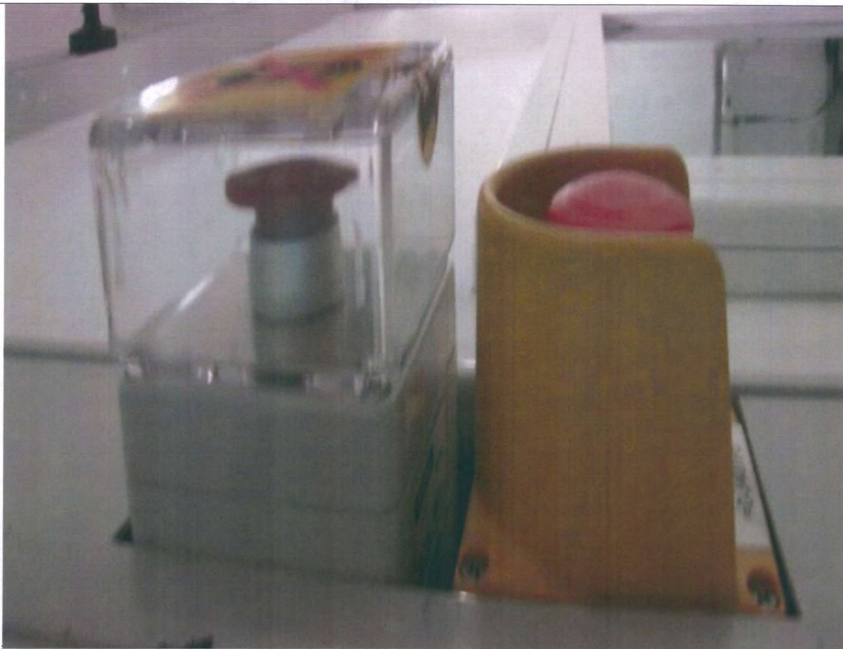
9.3 Блок аварийной сигнализации
