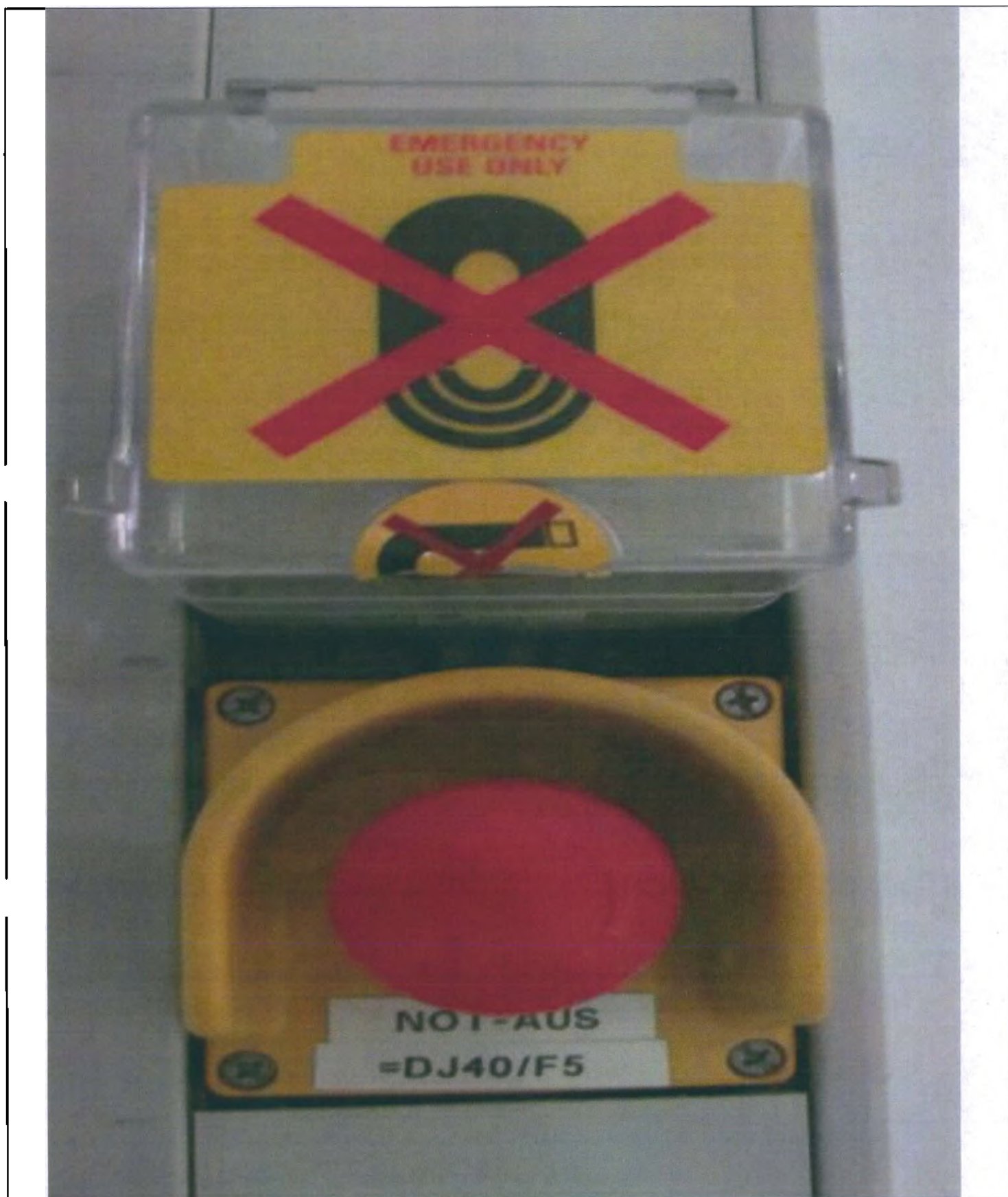
9.2 Блок аварийной сигнализации
