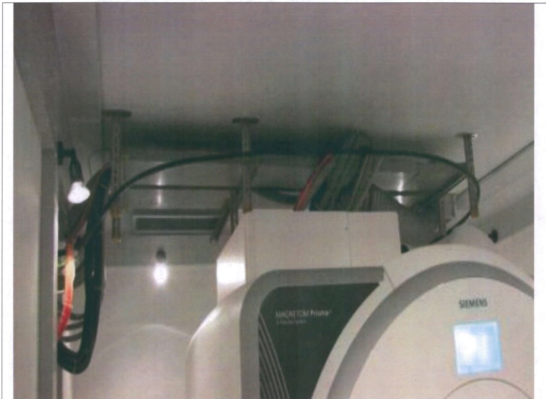
45.2 Кабельные соединения системы стационарные
