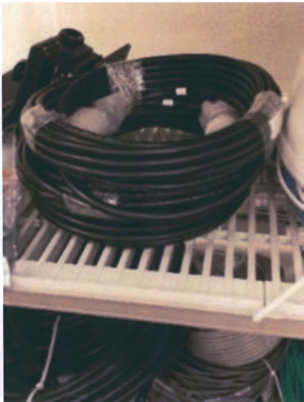
Фото 93. Кабели для подключения
