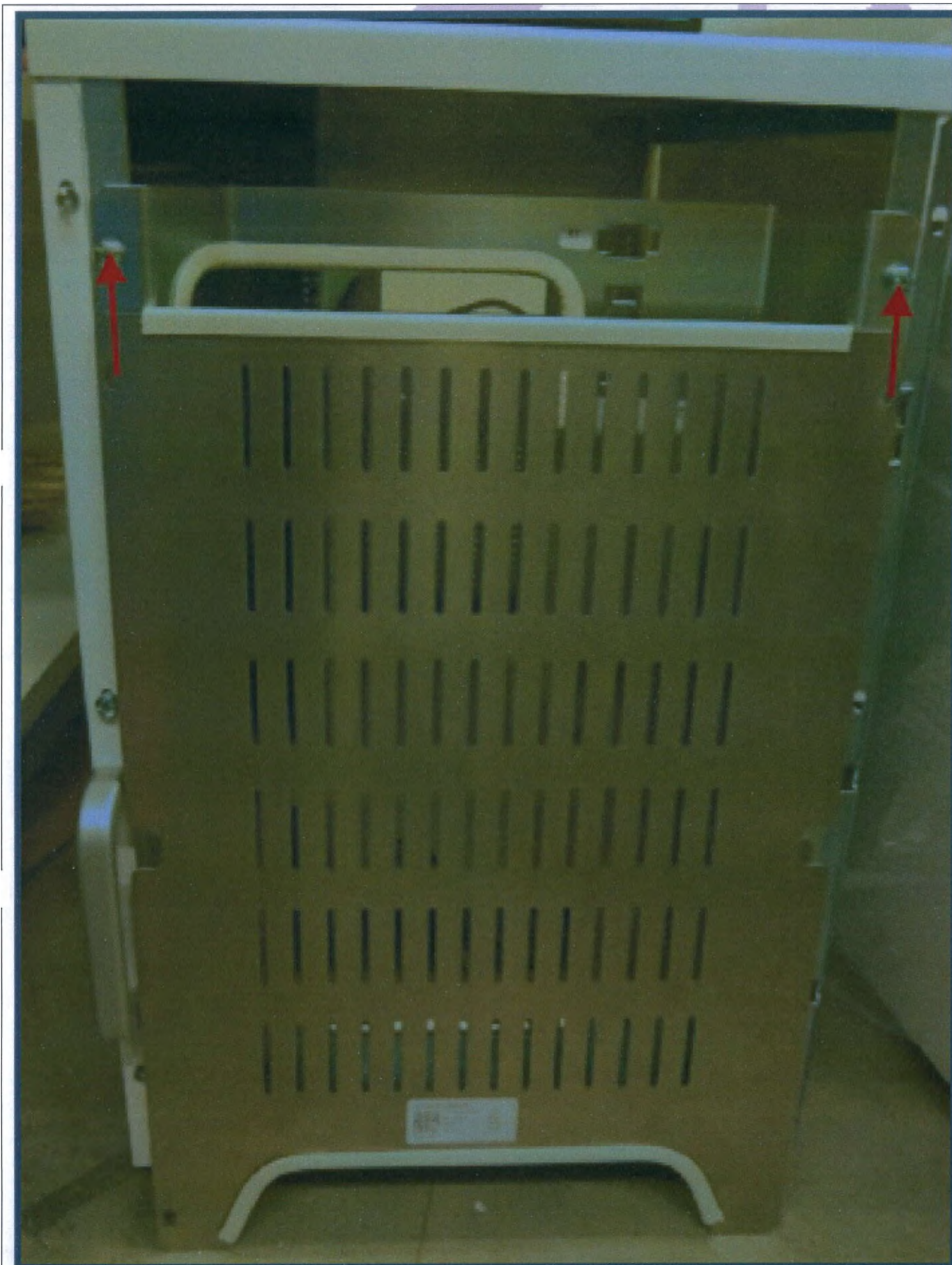
61. Шкаф для кабелей.
