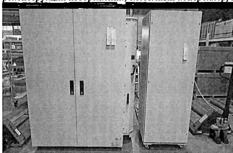
Рис. 19 Внешний вид центрального шкафа управления
