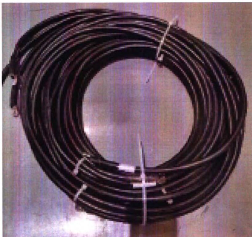
Фото 14 Кабель от блока питания к Гентри (низкое напряжение)
