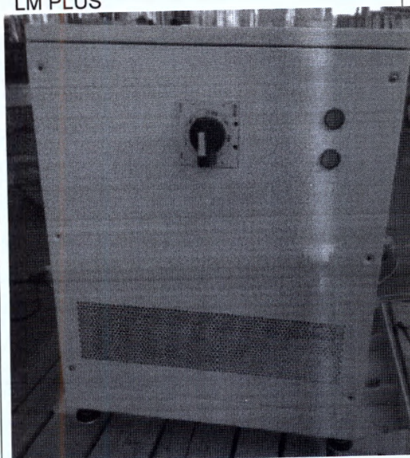
Силовой трансформатор CT-PDU-115KVA-3
