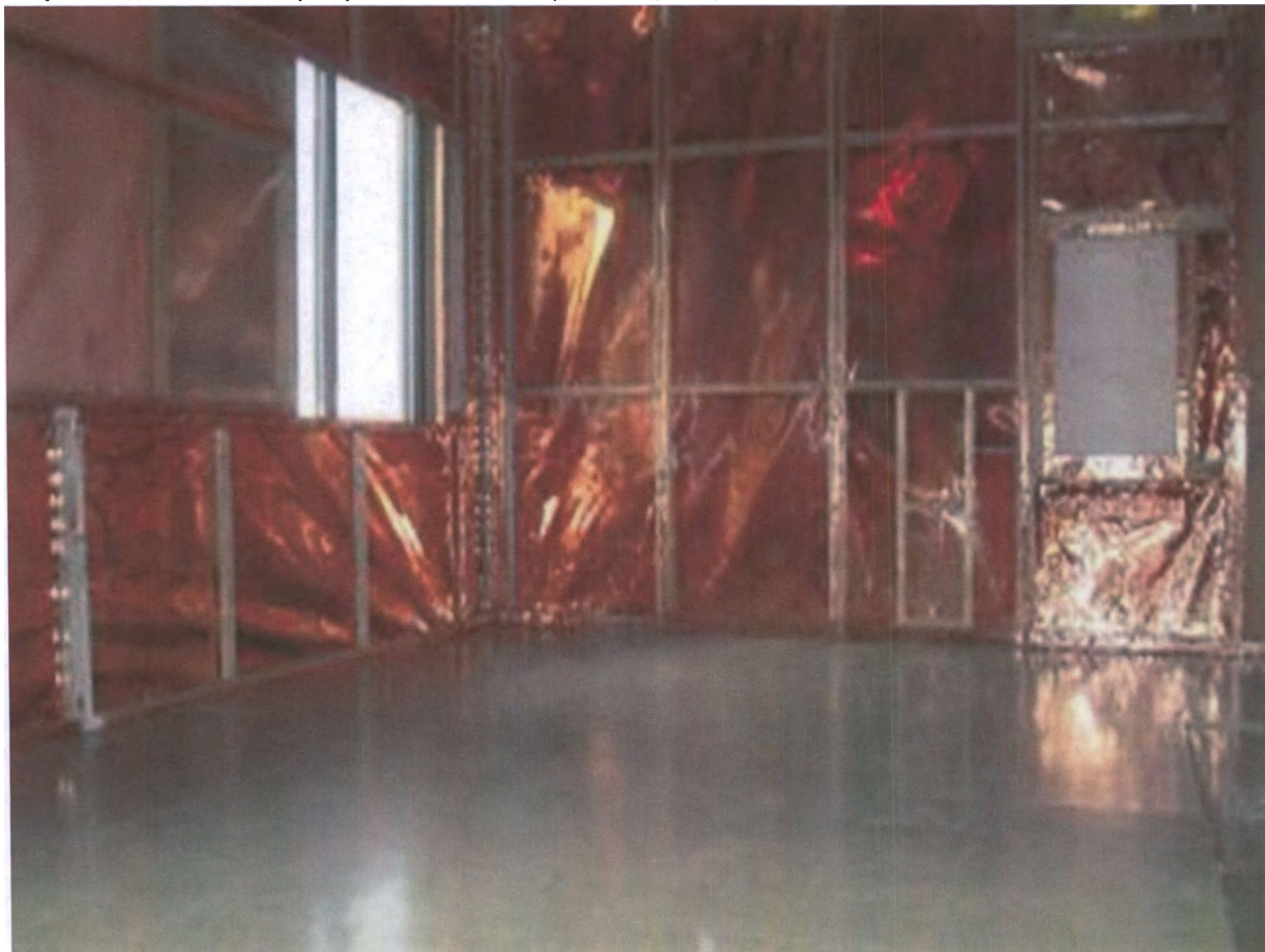
Устройство для защитного экранирования помещения (Клетка Фарадея)
