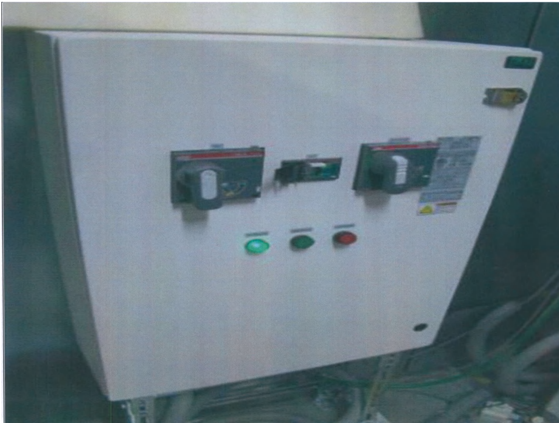
Щит силовой распределительный
