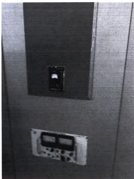
Рисунок 1.16 - Шкаф управления включением/выключением системы
