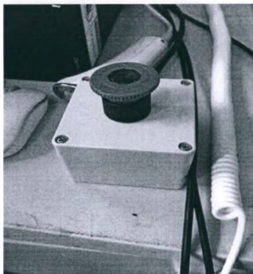
Выключатель аварийной остановки на рабочем месте оператора.
