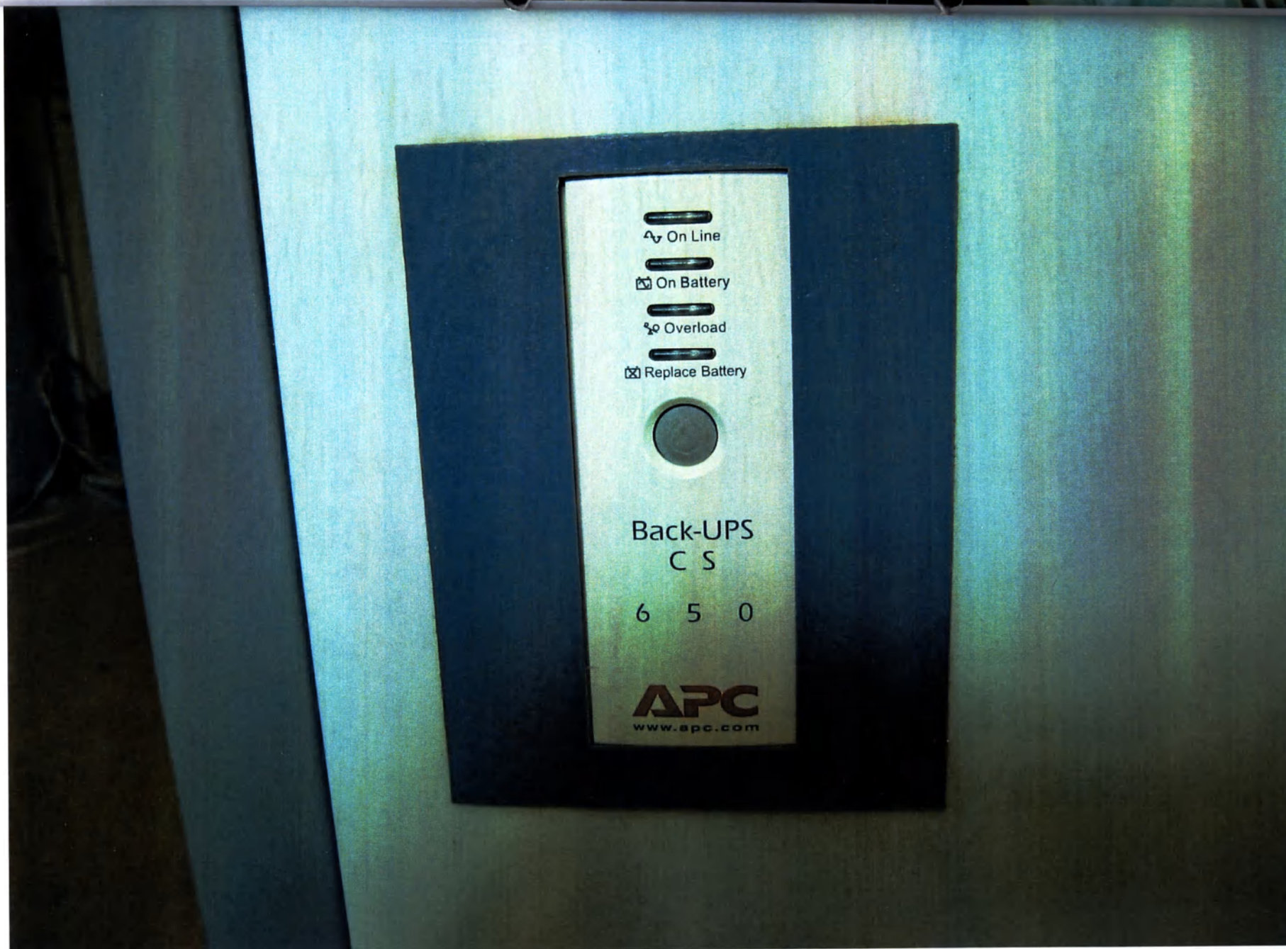
Электронная панель на блоке управления
