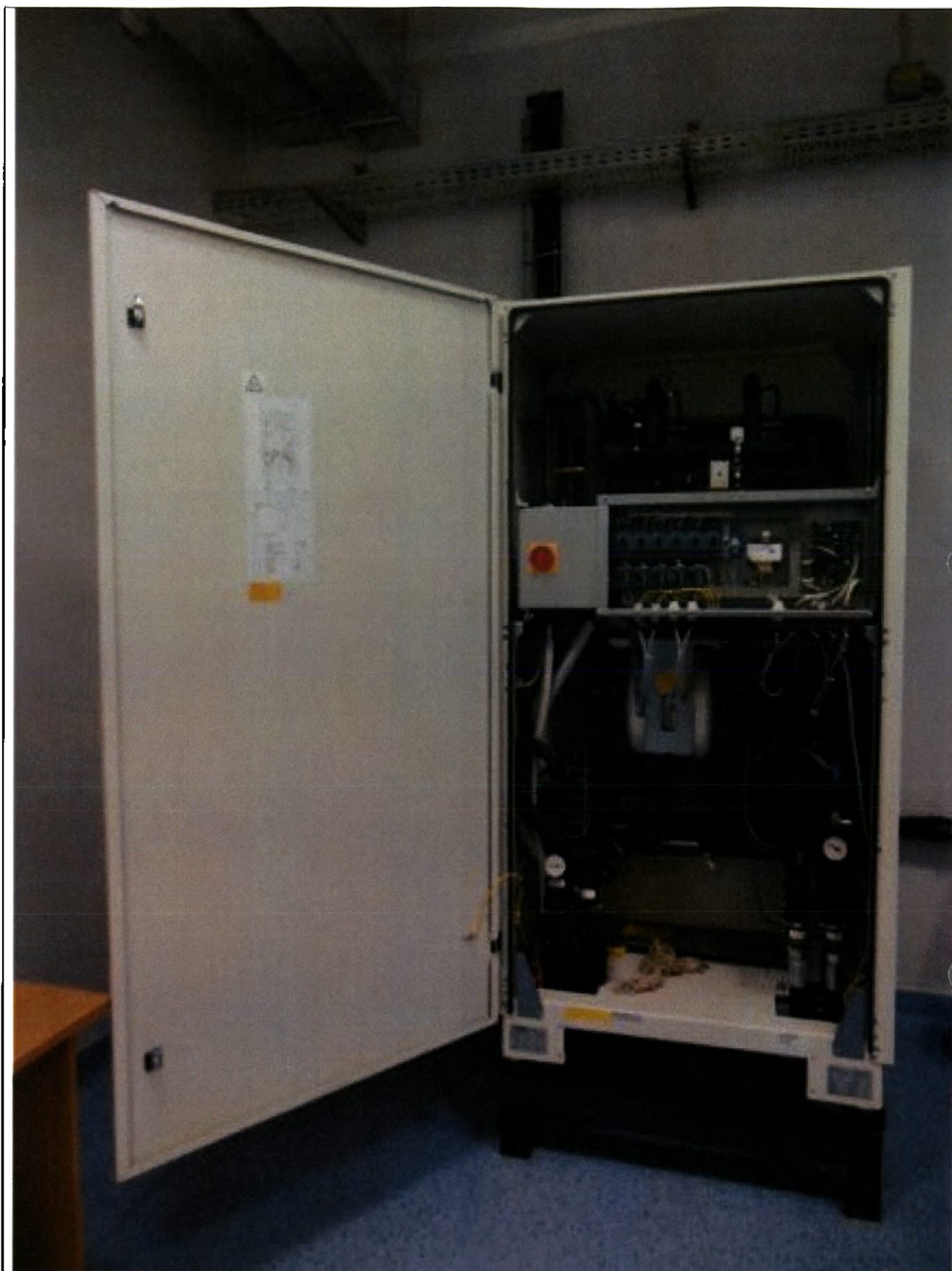
33.2 Система охлаждения/ кондиционирования гентри.
