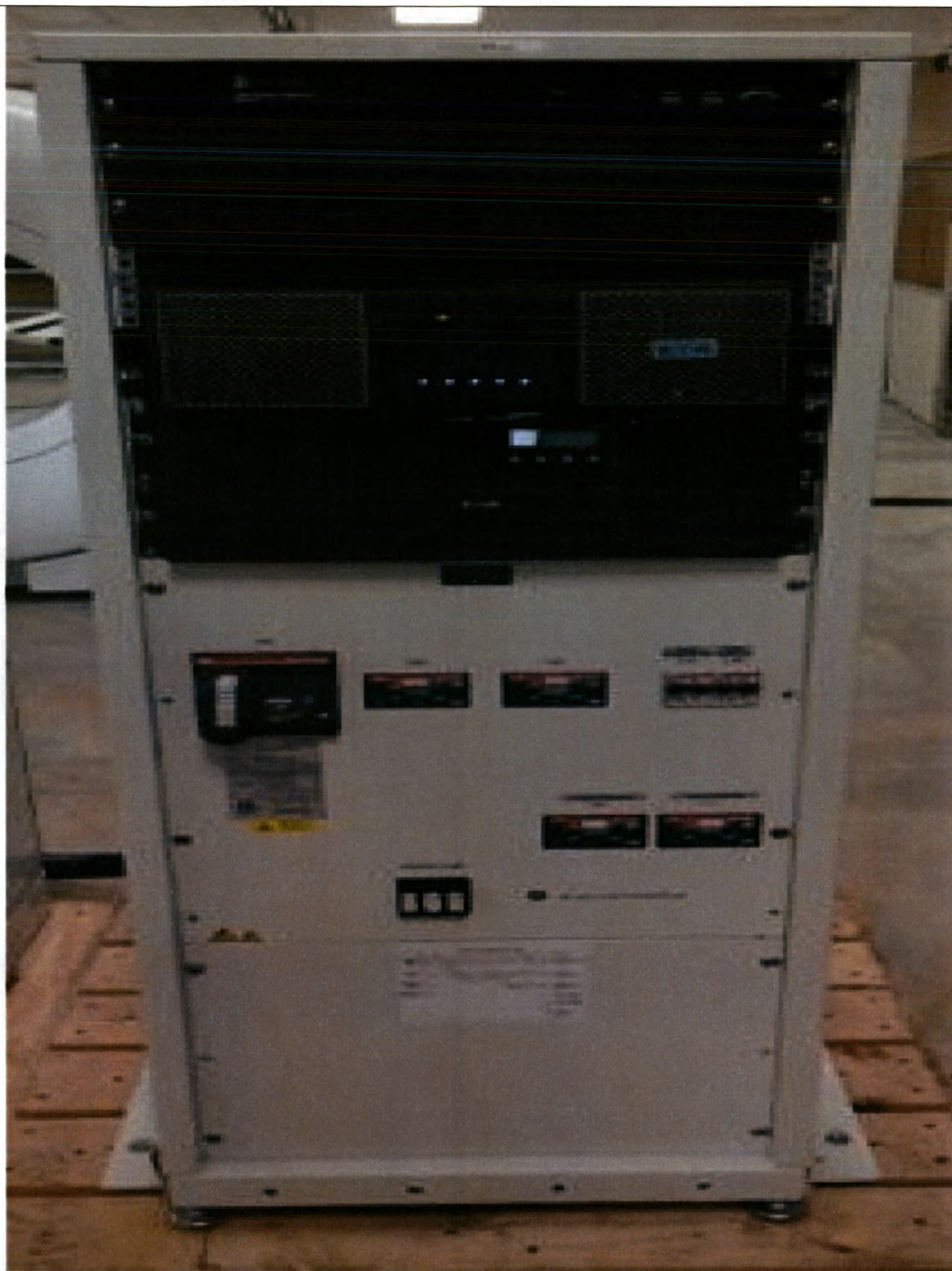
27.1 Набор инсталляционный: электрощит распределительный
