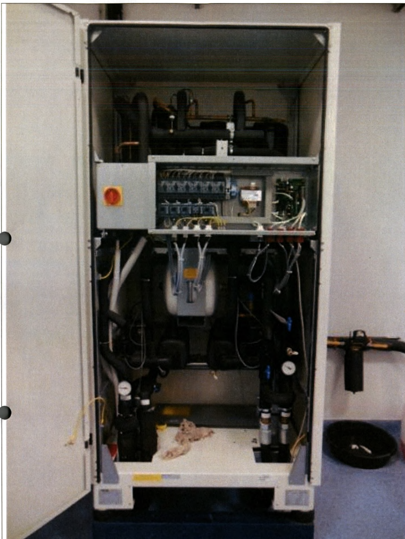
33.1 Система охлаждения/ кондиционирования гентри.
