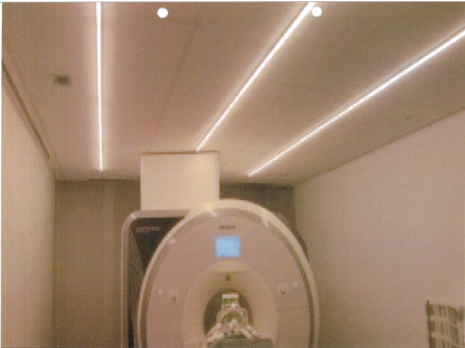
72. Облицовка радиочастотной кабины.
