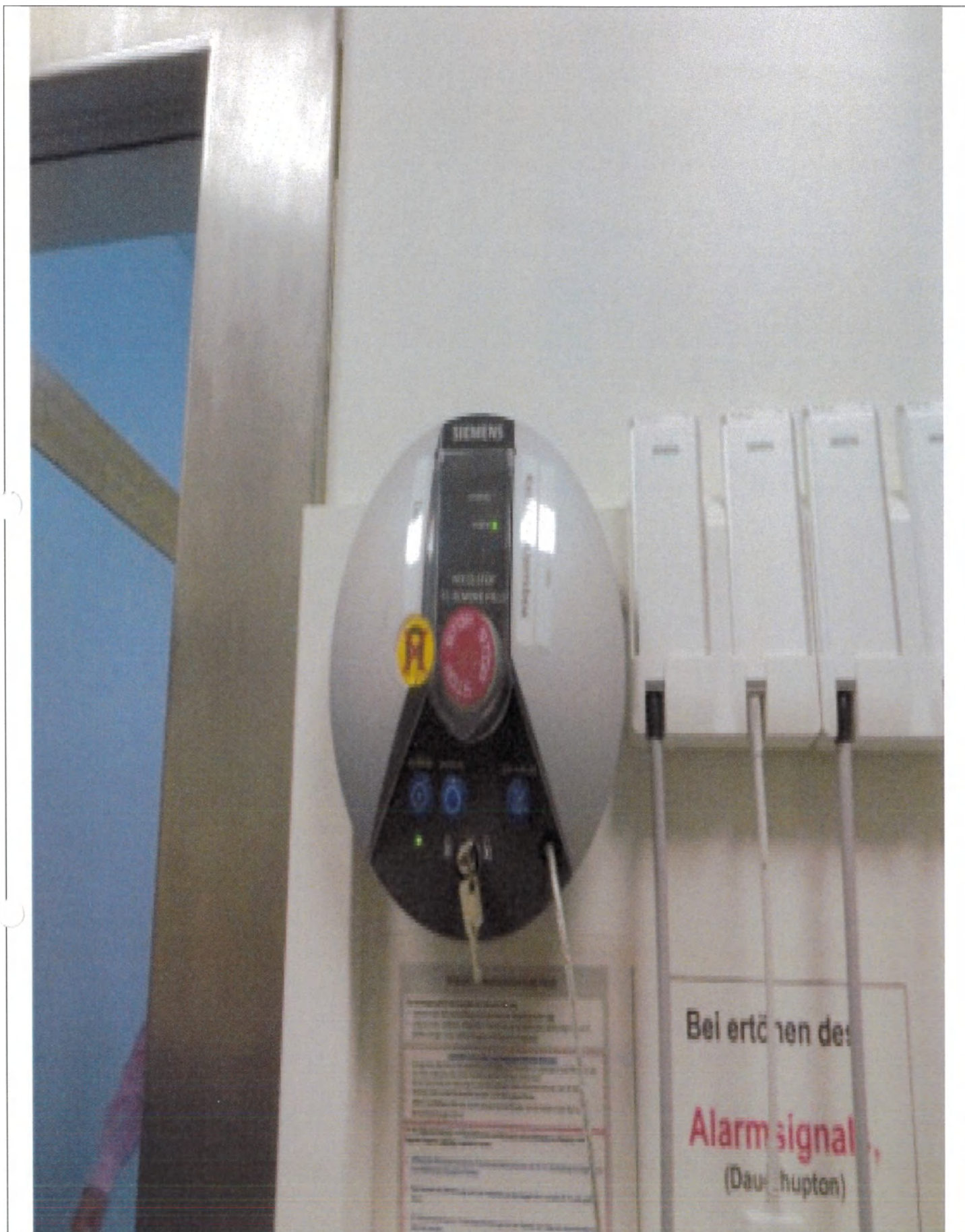
9. Пульт аварийного выключения системы.
