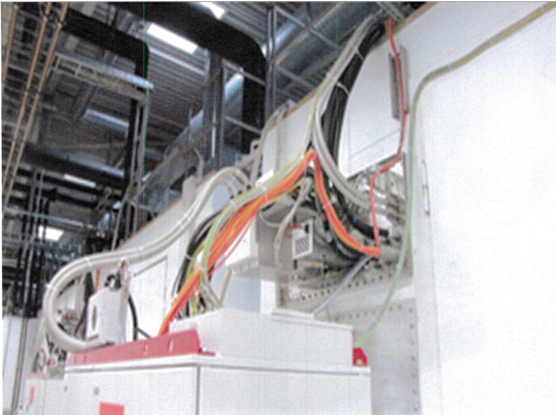
43. Кабельные соединения системы стационарные;
