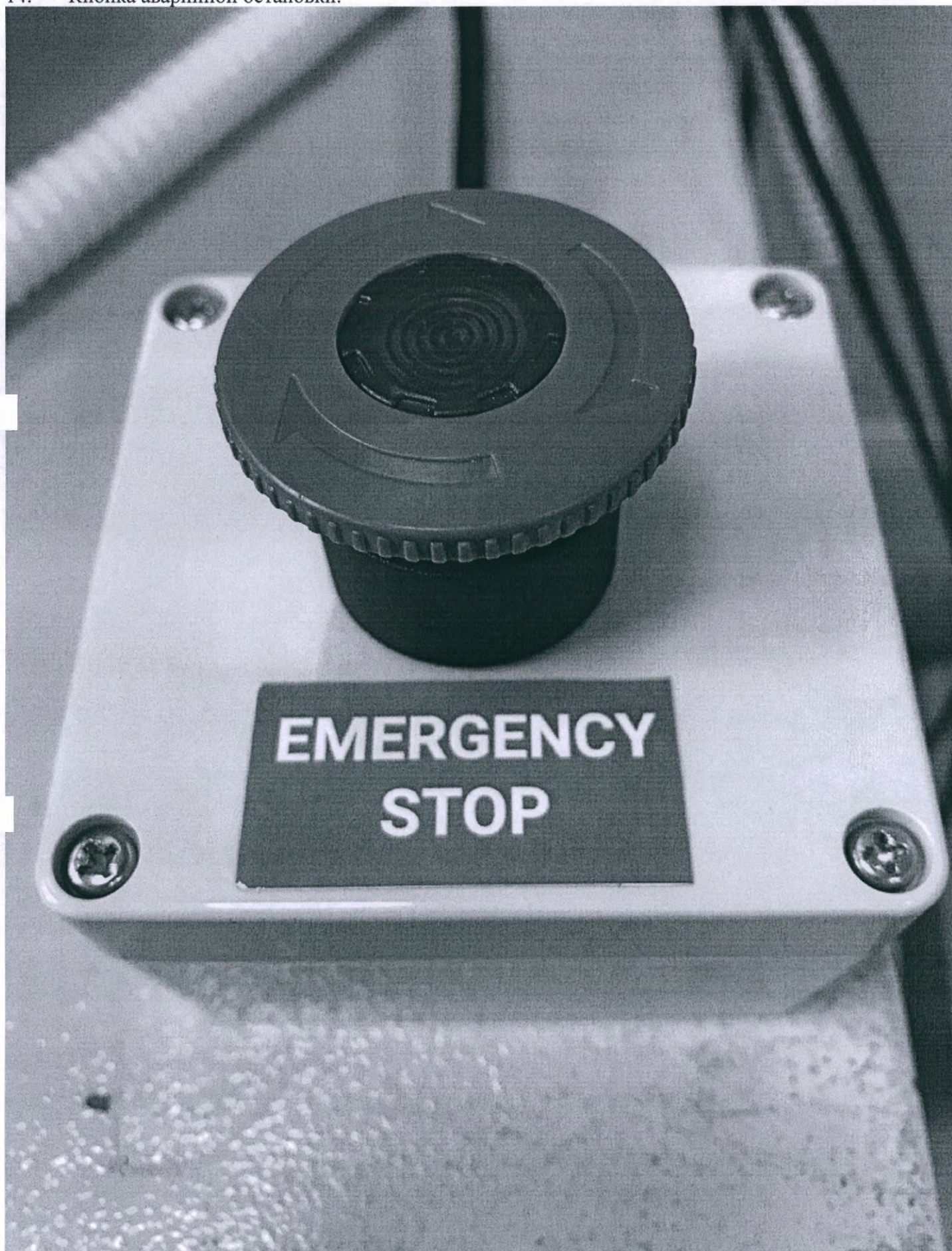
14. Кнопка аварийной остановки.
