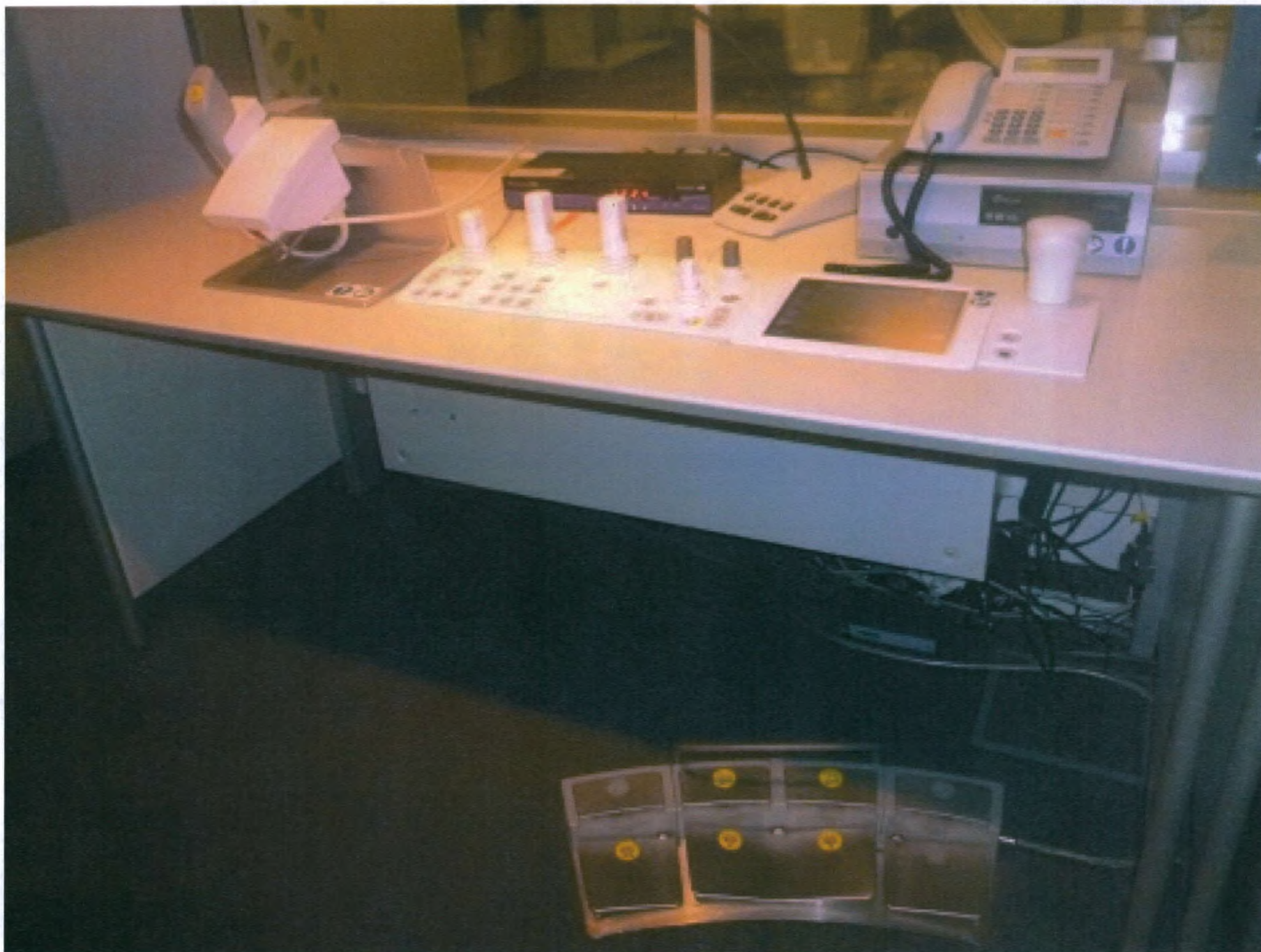
71. Коннектор для консоли управления системой дополнительной в пультовой.
