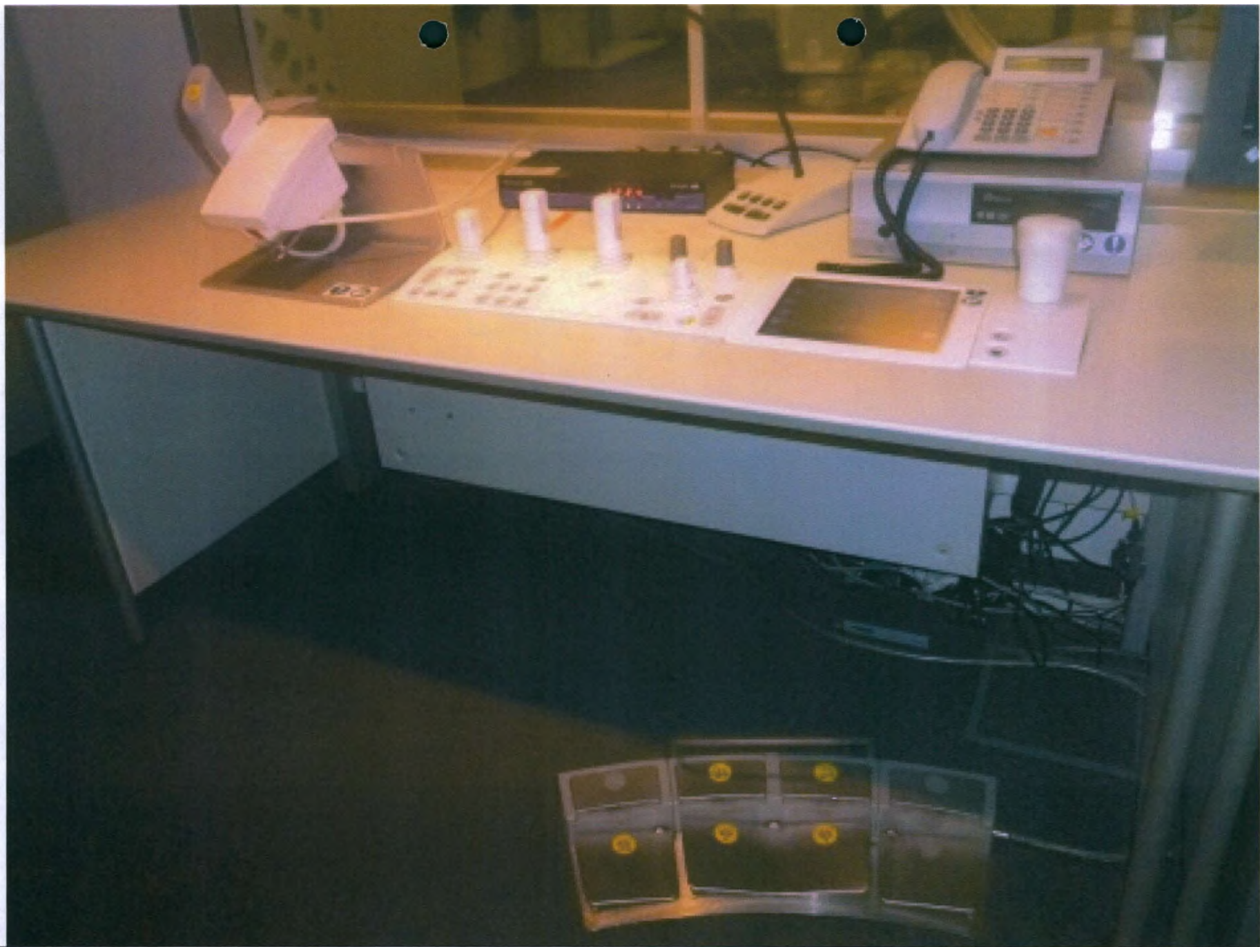
72. Консоль управления системой дополнительная в пультовой.
