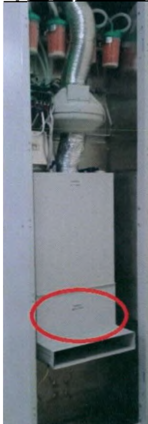
а) Камера воздушных фильтров
