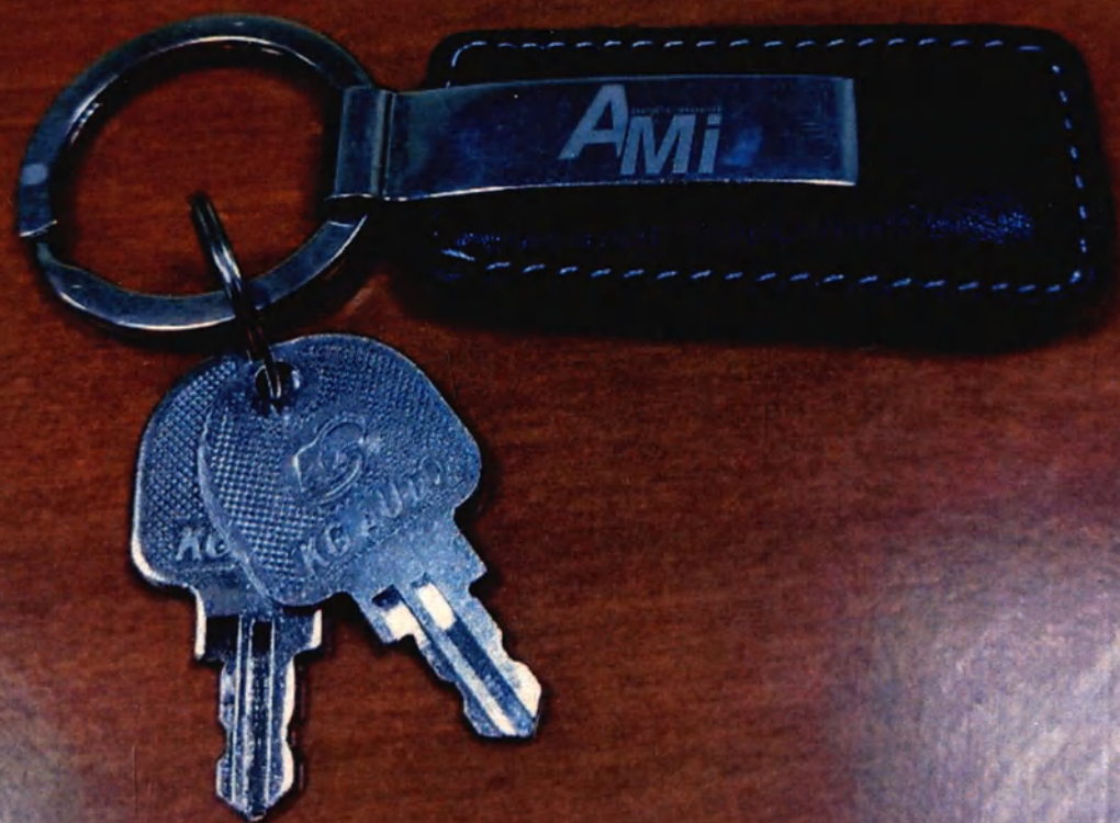
Ключ для включения-выключения подачи электроэнергии к оборудованию
