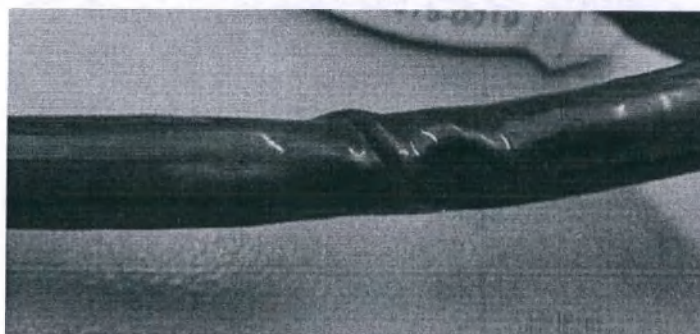
Рис. 59. Поврежденный кабель Мотора
