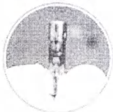
Нерабочий предохранитель, Заменить
