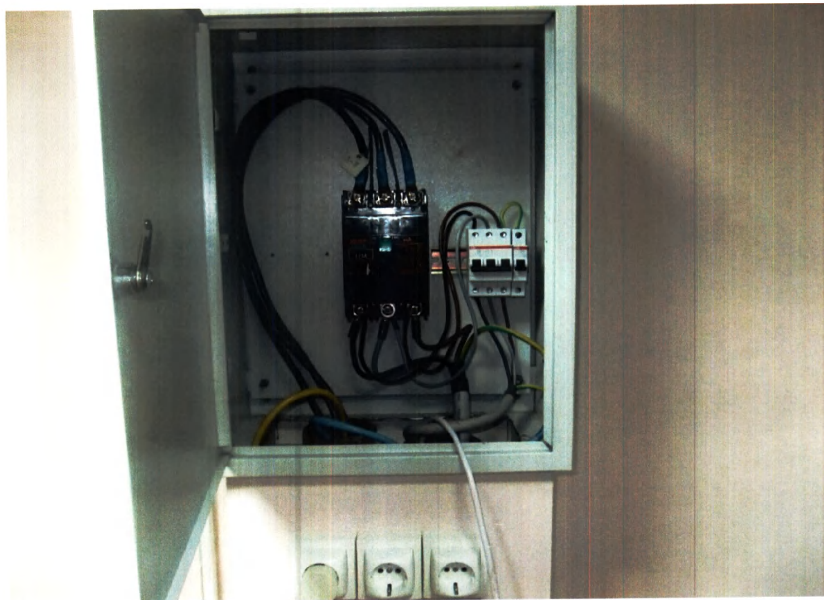
22. Щит электрический распределительный
