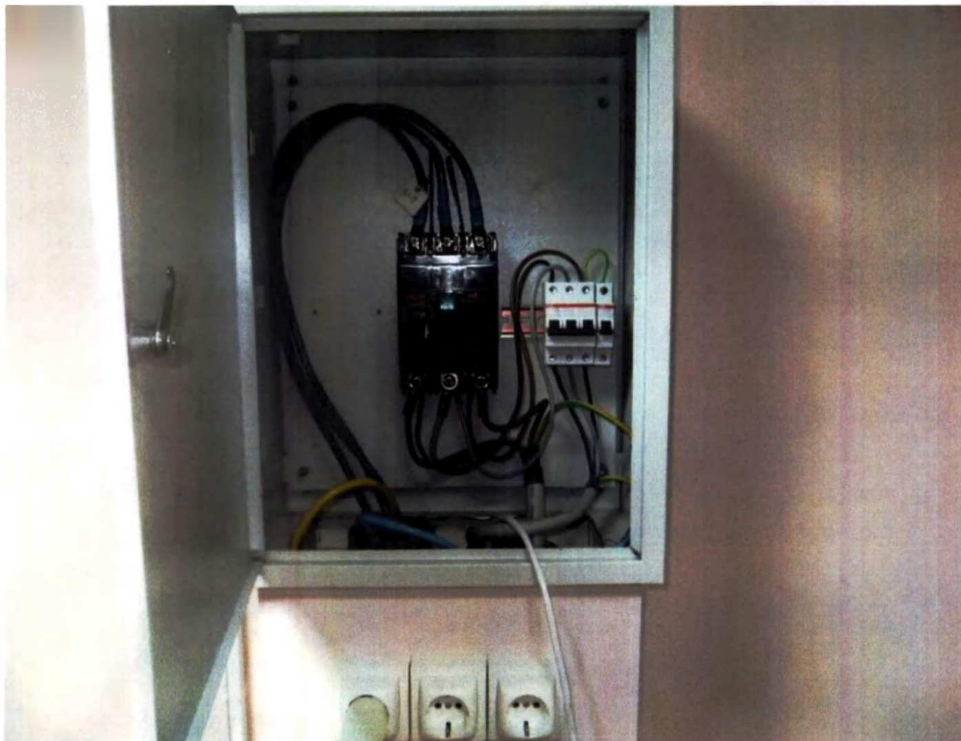
23. Щит электрический распределительный:
