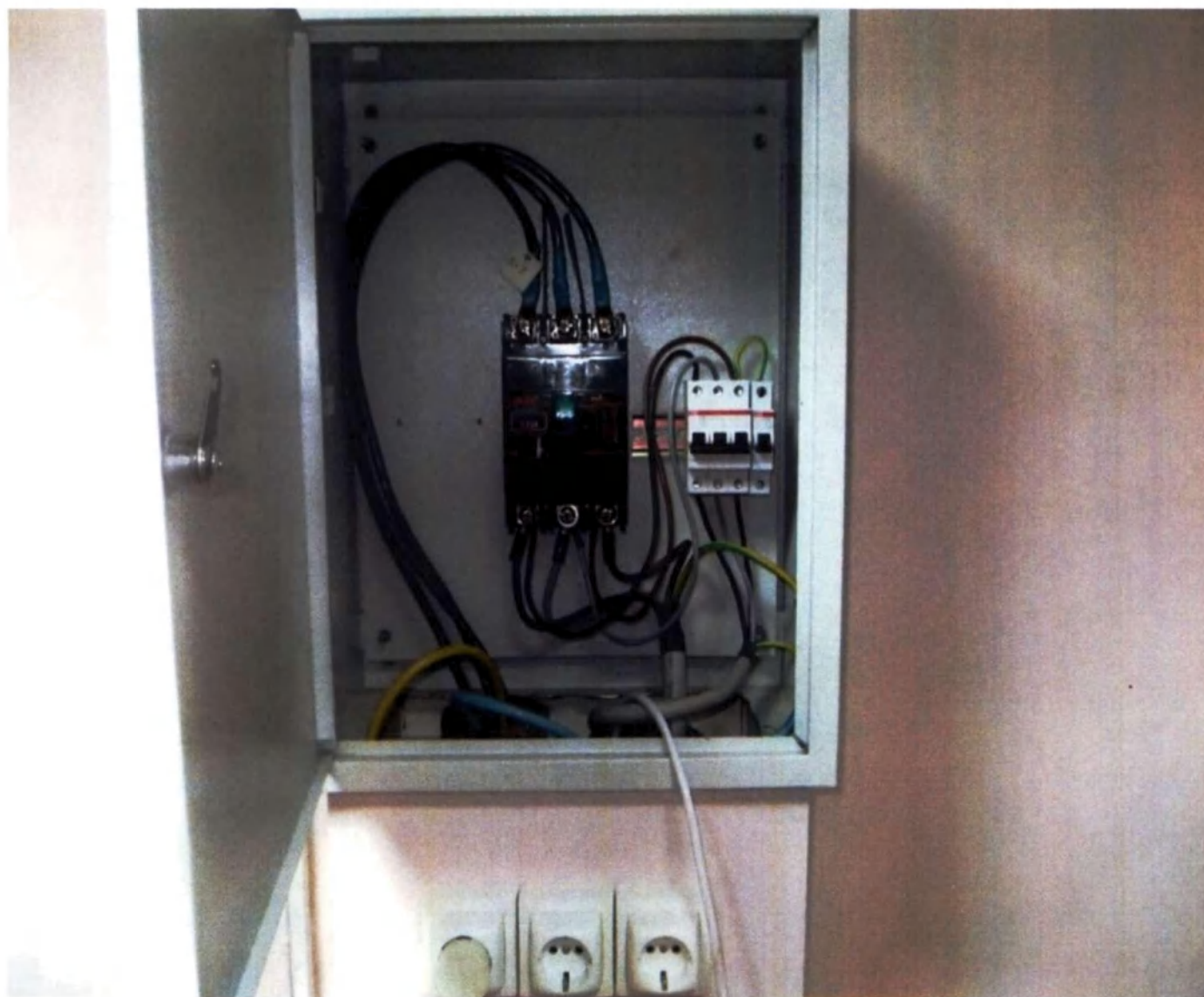
20. Щит электрический распределительный:
