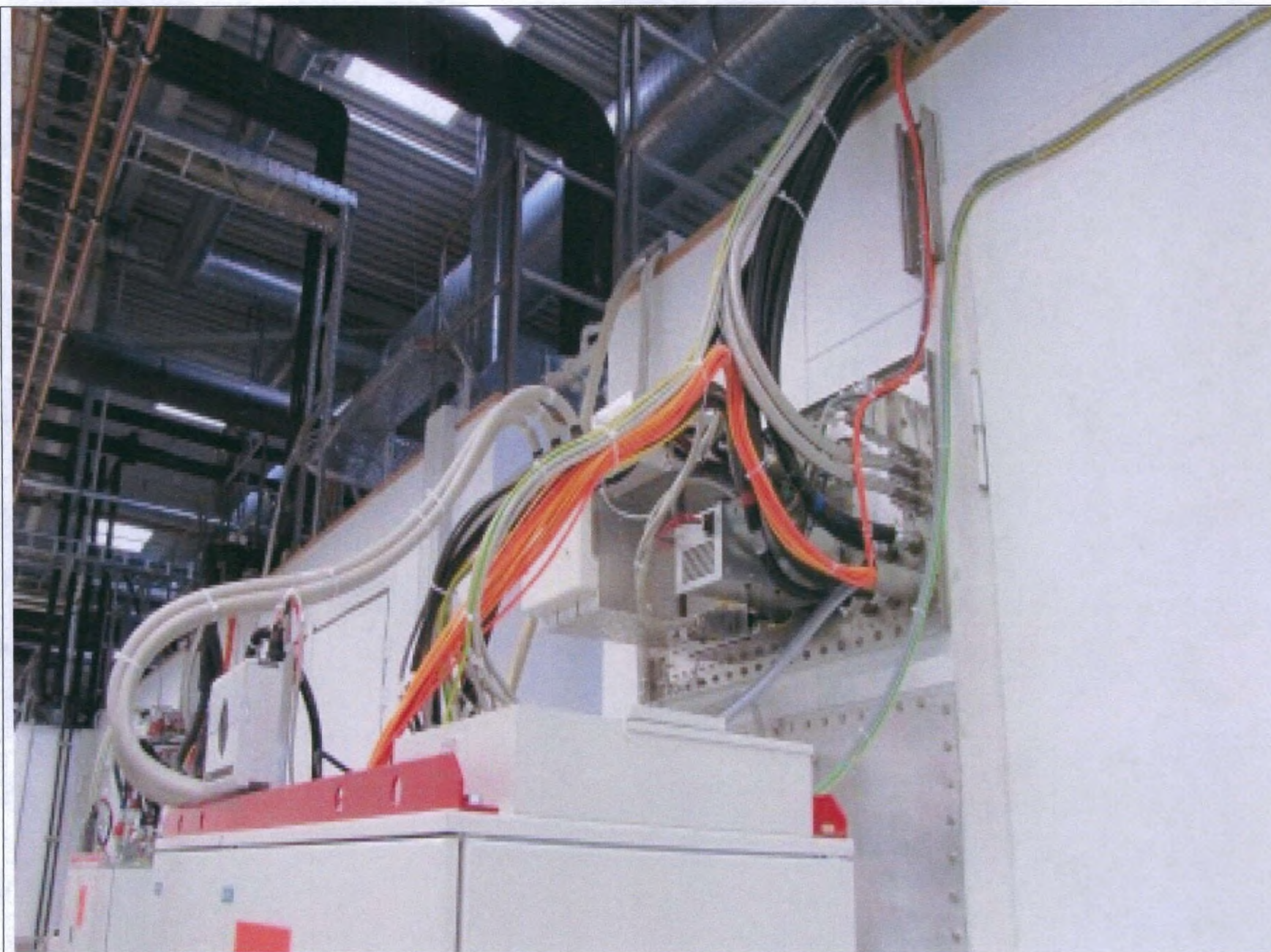
43. Кабельные соединения системы стационарные.
