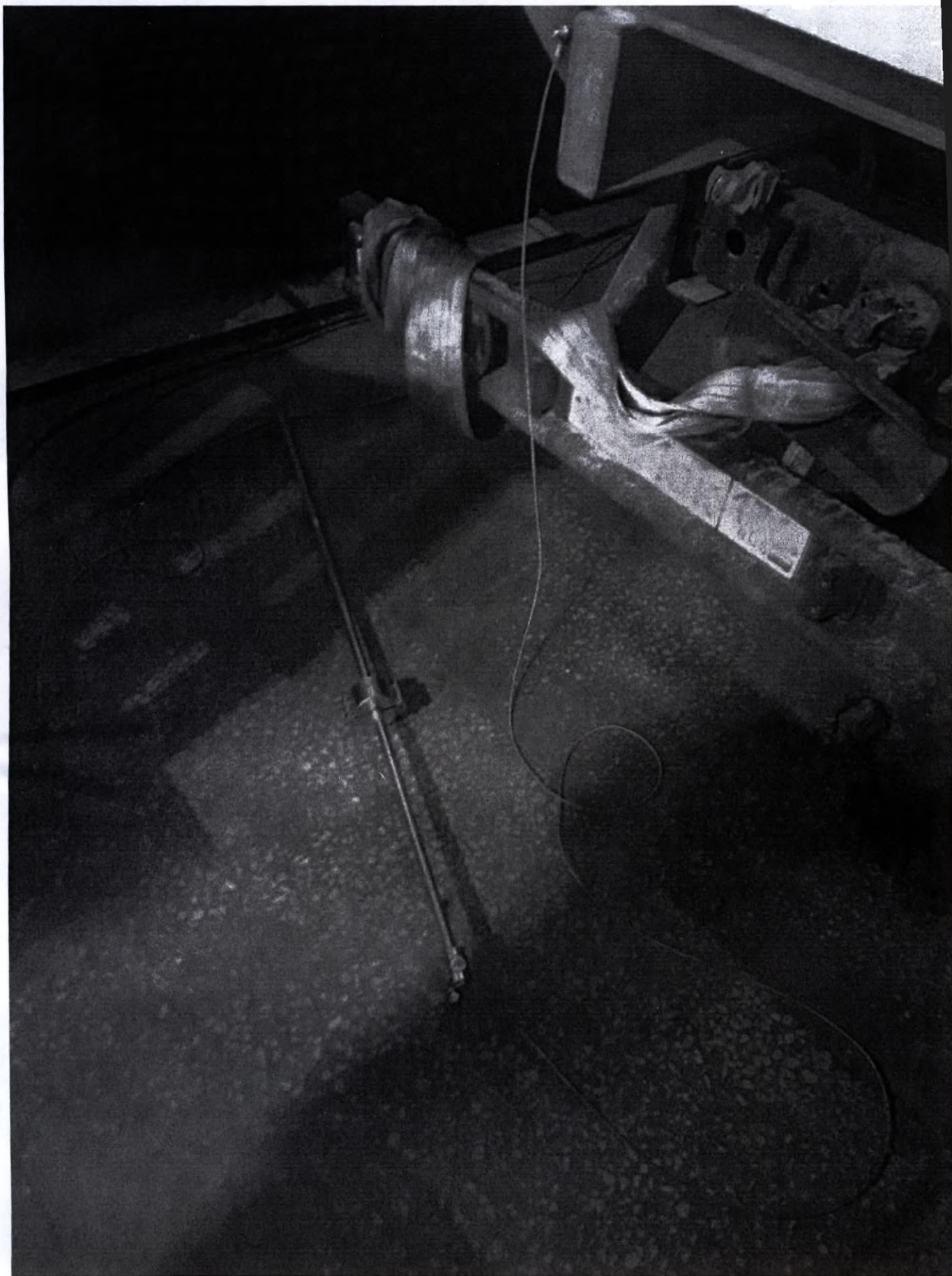
Фотография 50. Заземляющее устройство. Общий вид.
