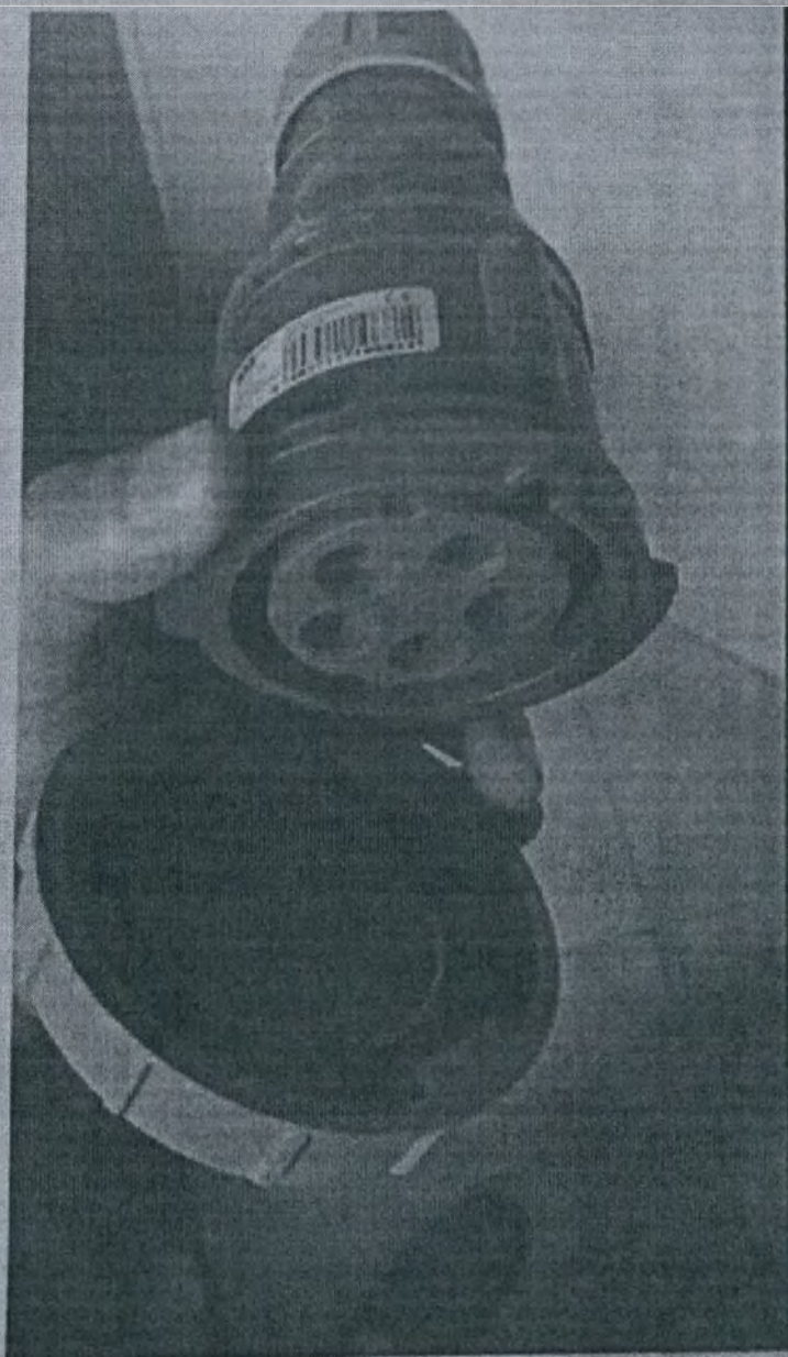
ФОТО 32. Силовая розетка (3-phase power socket)
