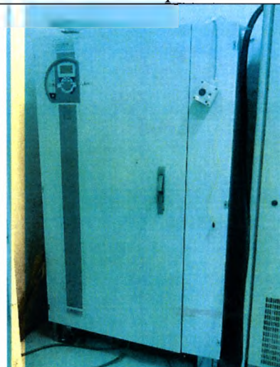
31. Щиты распределительные (от 1 до 2 штук).
