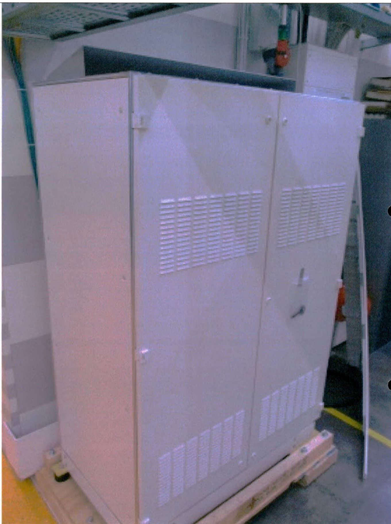
7. Блок к подключению линии питания.
