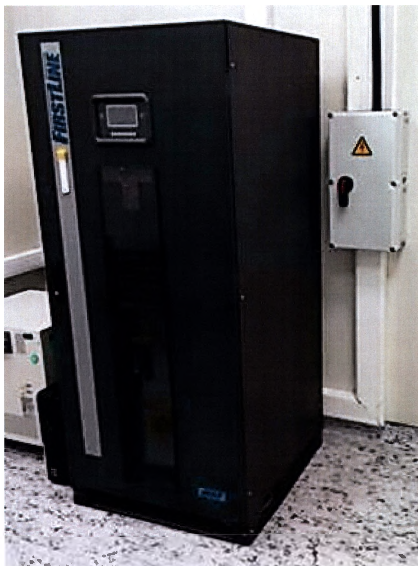
Рисунок 42 – Фотографическое изображение источника бесперебойного питания (шкаф управления).
