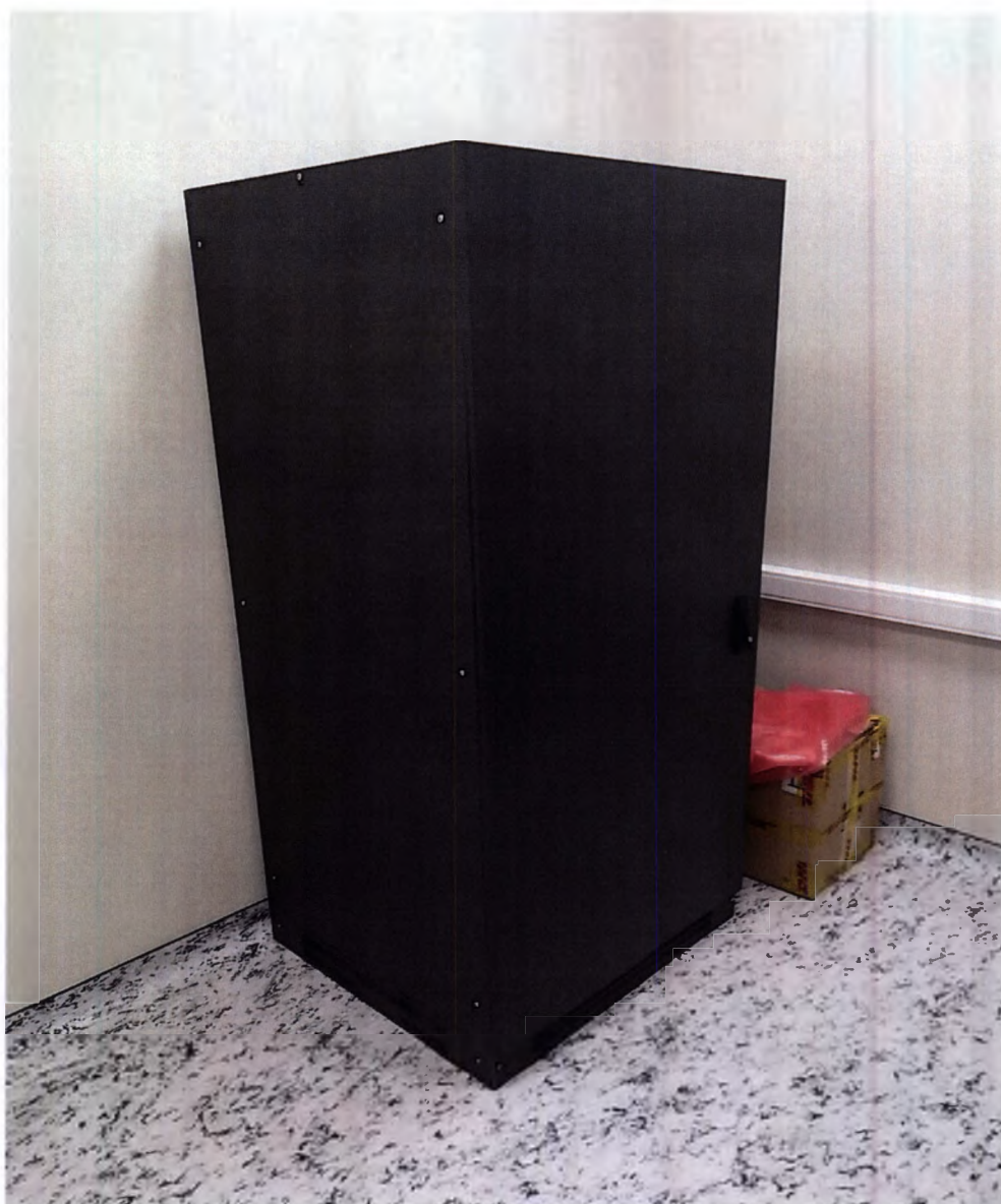
Рисунок 43 – Фотографическое изображение источника бесперебойного питания (шкаф с батареями).
