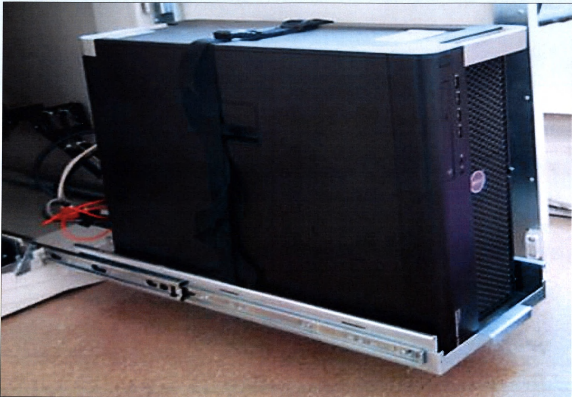
9а. Сервер реконструкции.
