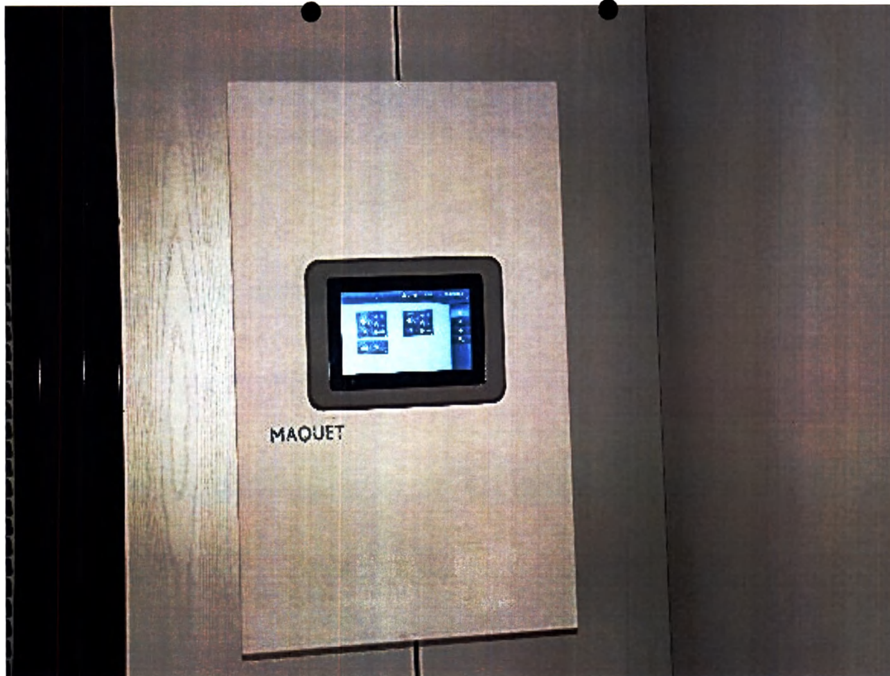
Фото 13. Настенные панели управления - не более 3 шт. (при необходимости);
