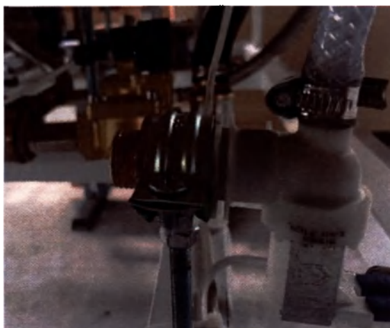
Рис. 8. Подключение охлаждающей воды
