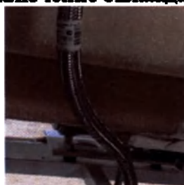
Рис. 9. Отвод охлаждающей воды
