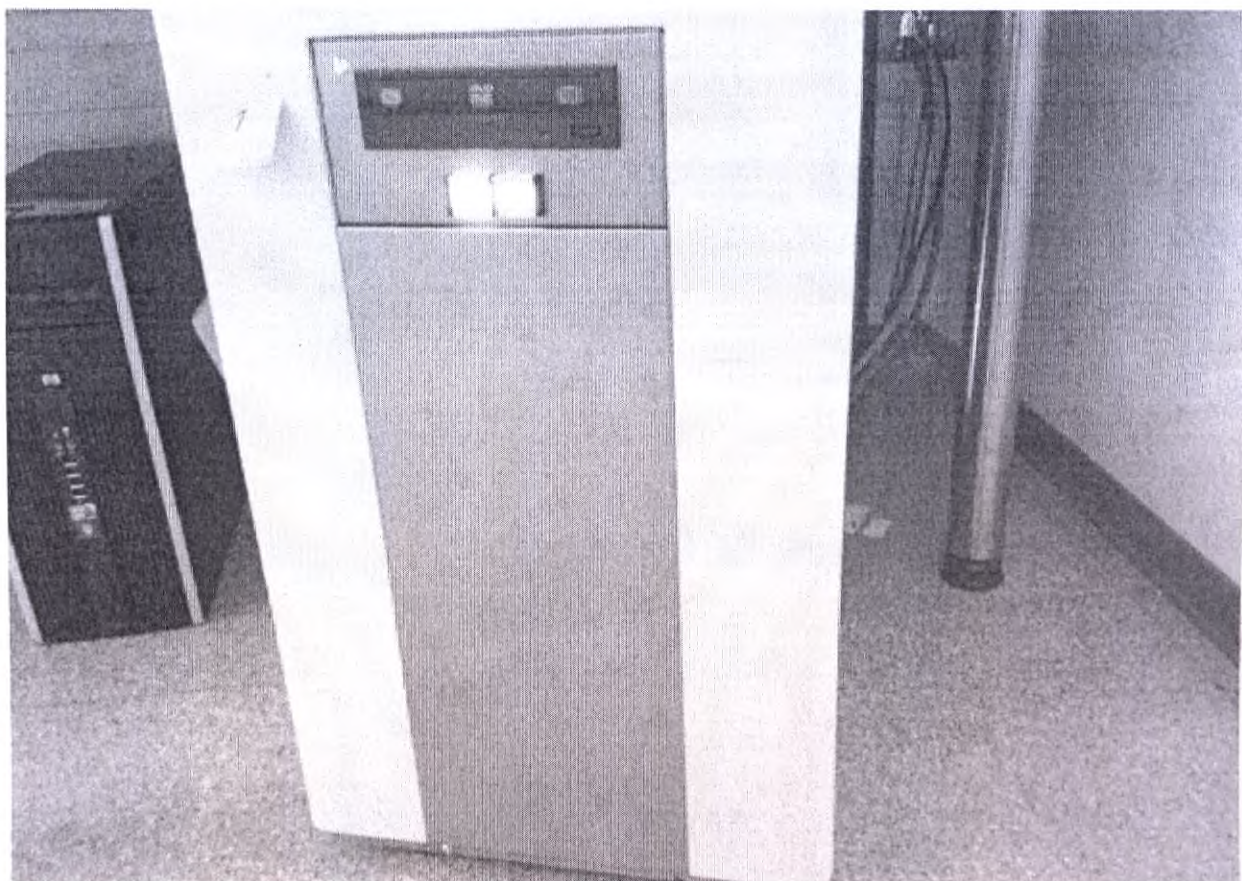
4. Консоль оператора. - центральный процессор;
