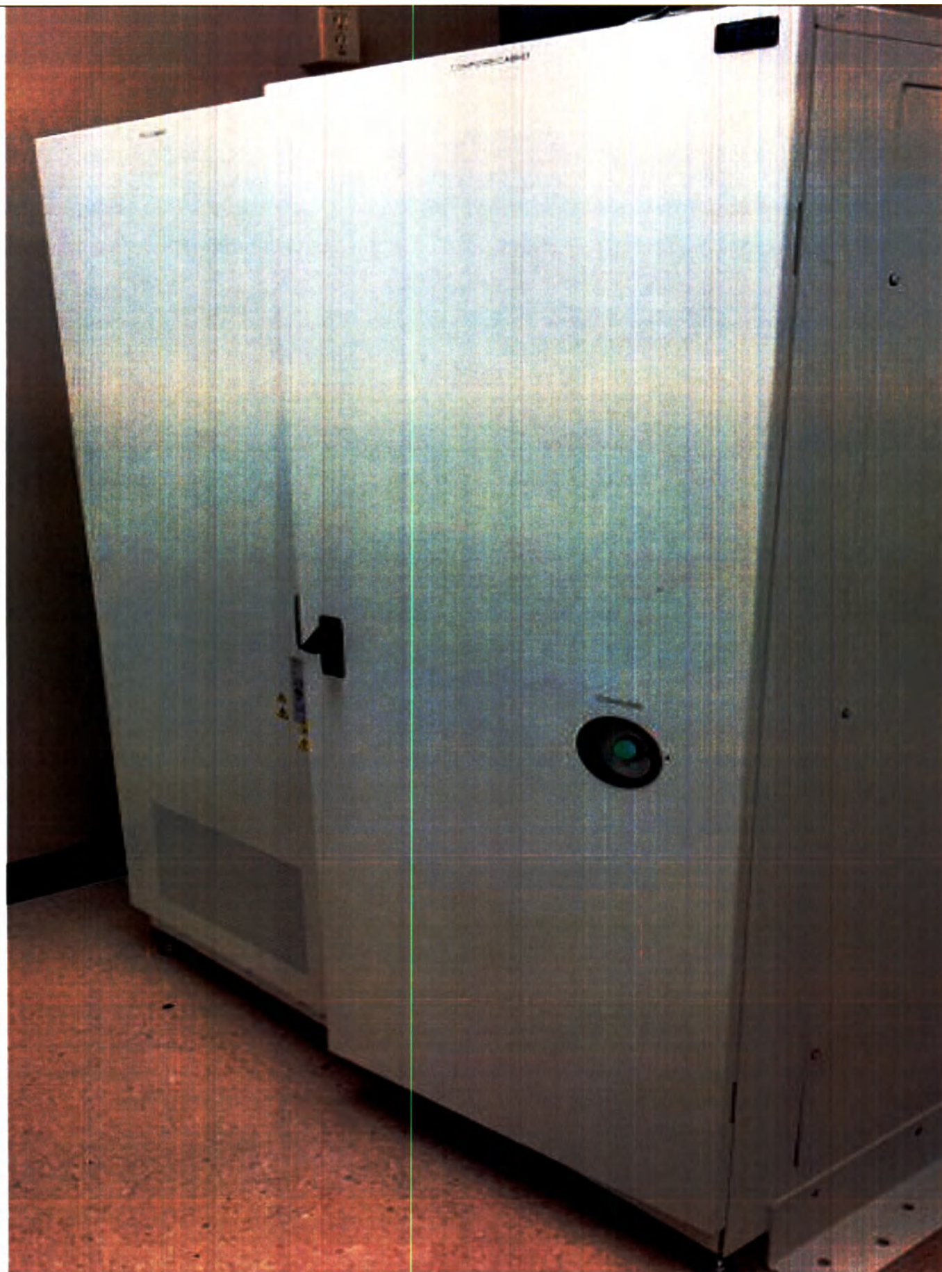
26. Набор инсталляционный для оптимизации точности системы: электрощит распределительный.
