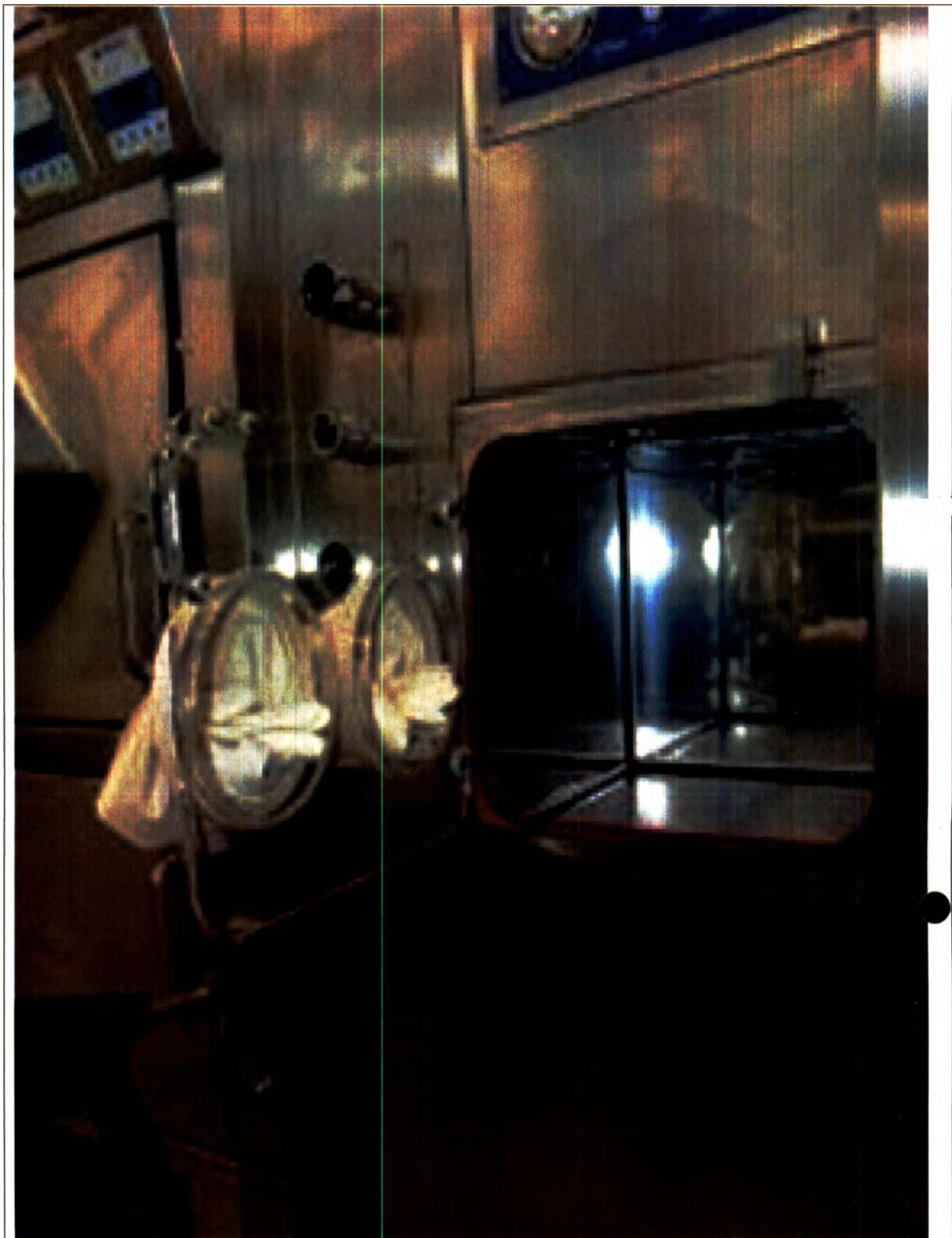
106. Камеры защитные для проведения контроля качества
