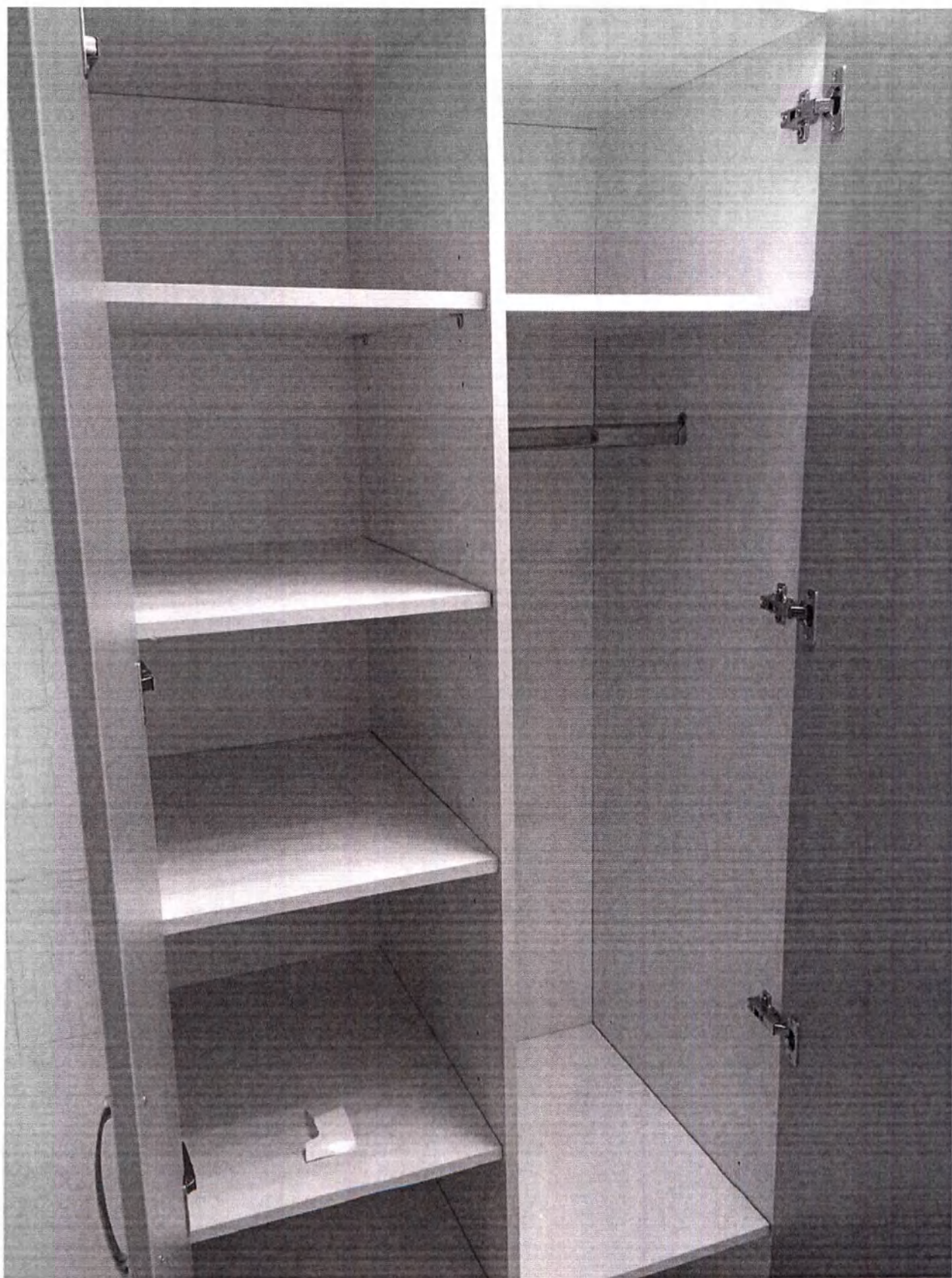
Фото 96 Шкаф модель М-ШОк-80 общий вид
