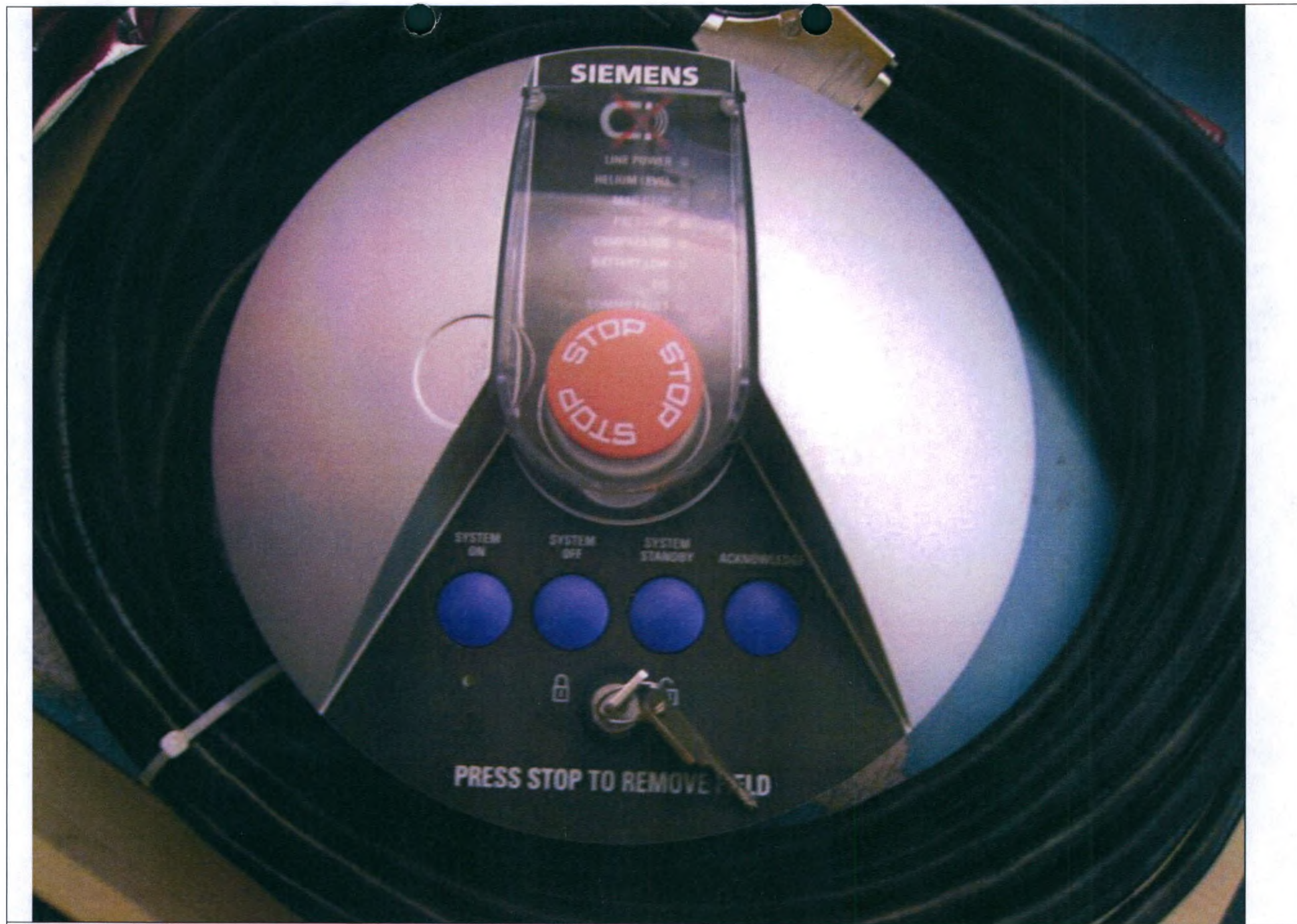
11. Пульт аварийного выключения системы.
