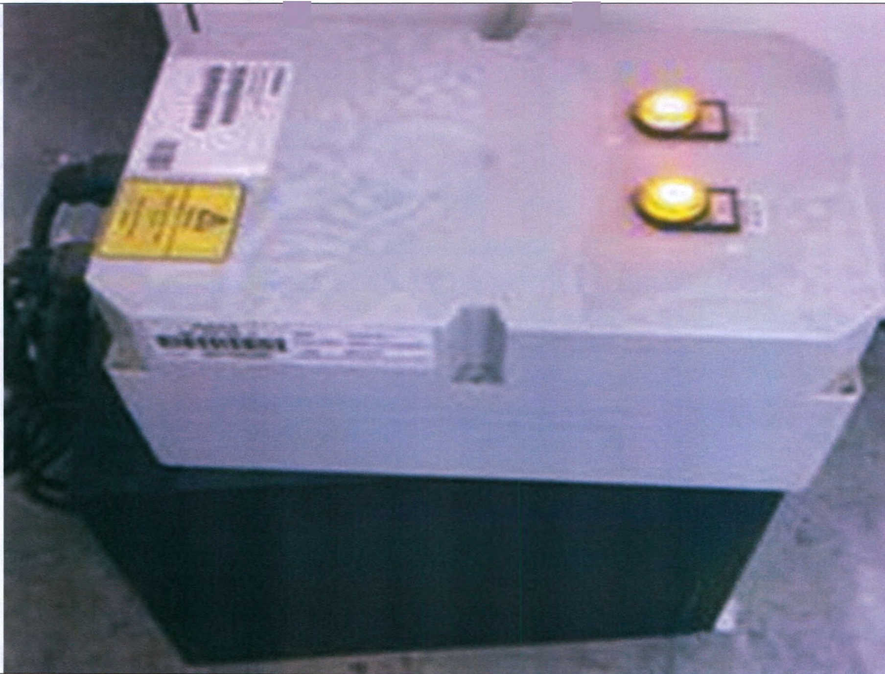
162. Система бесперебойного электроснабжения.
