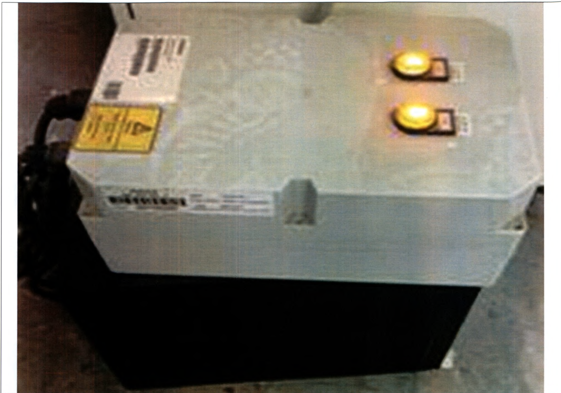
159. Система бесперебойного электроснабжения.
