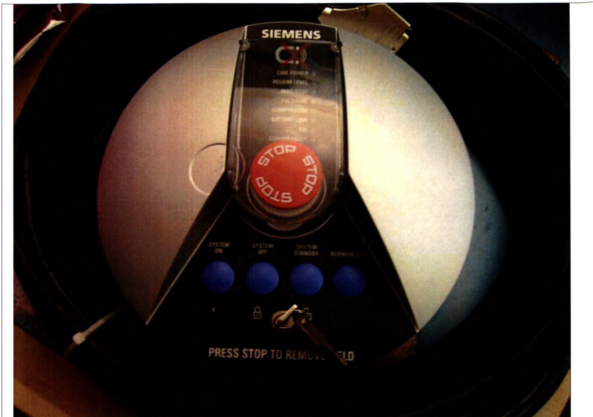
11. Пульт аварийного выключения системы.
