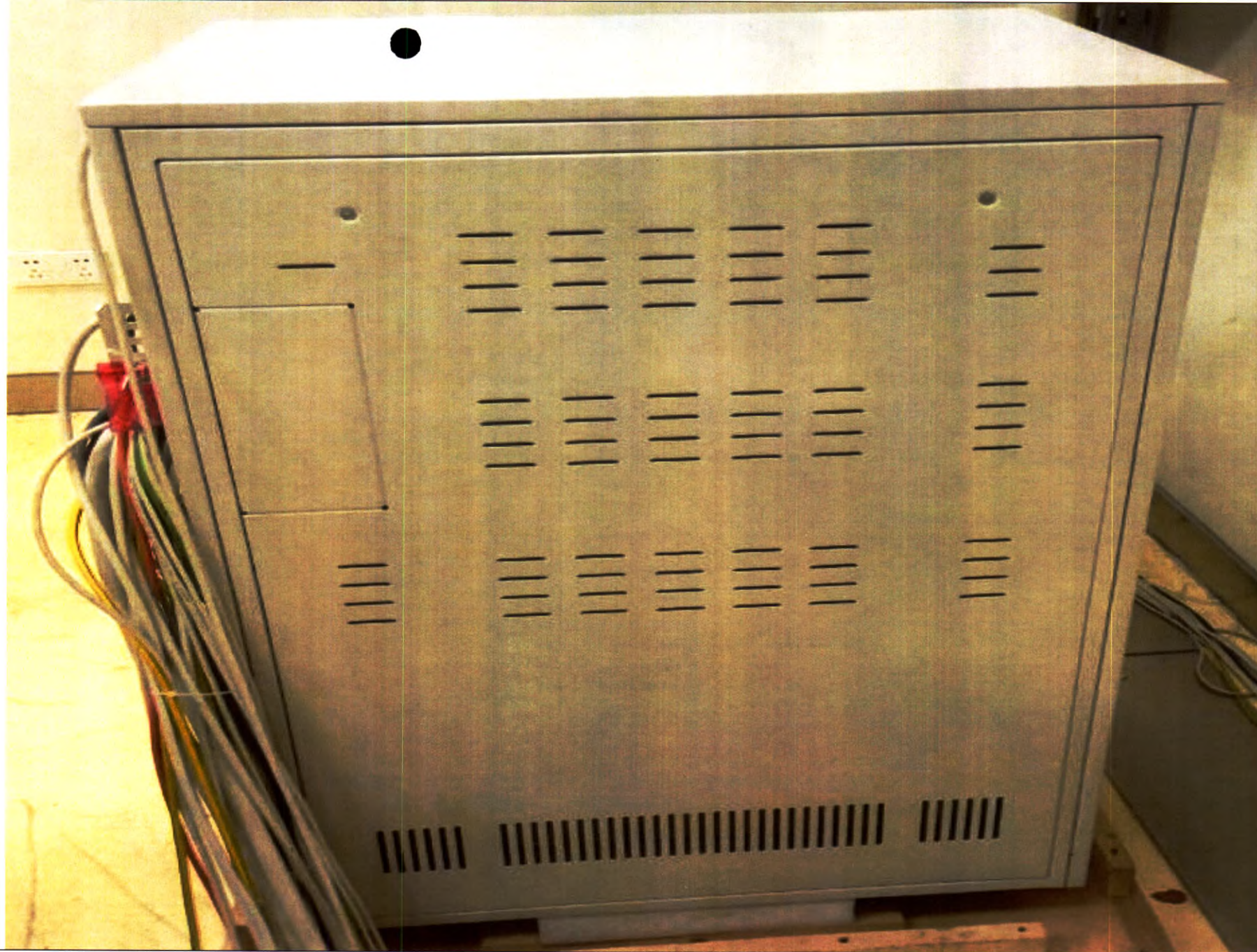
6. Генератор 50 кВт/65 кВт.
