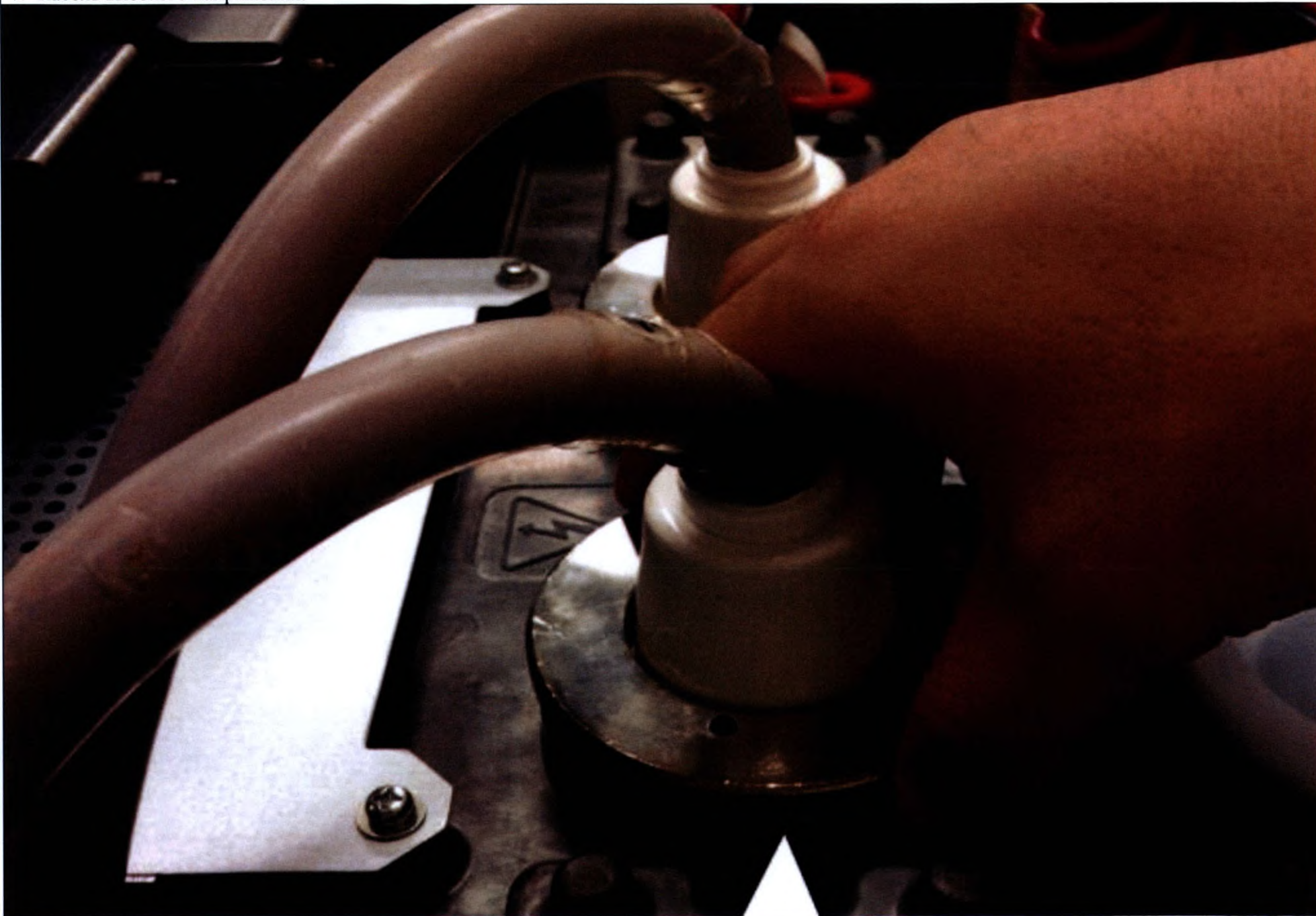
7. Кабель высокого напряжения.
