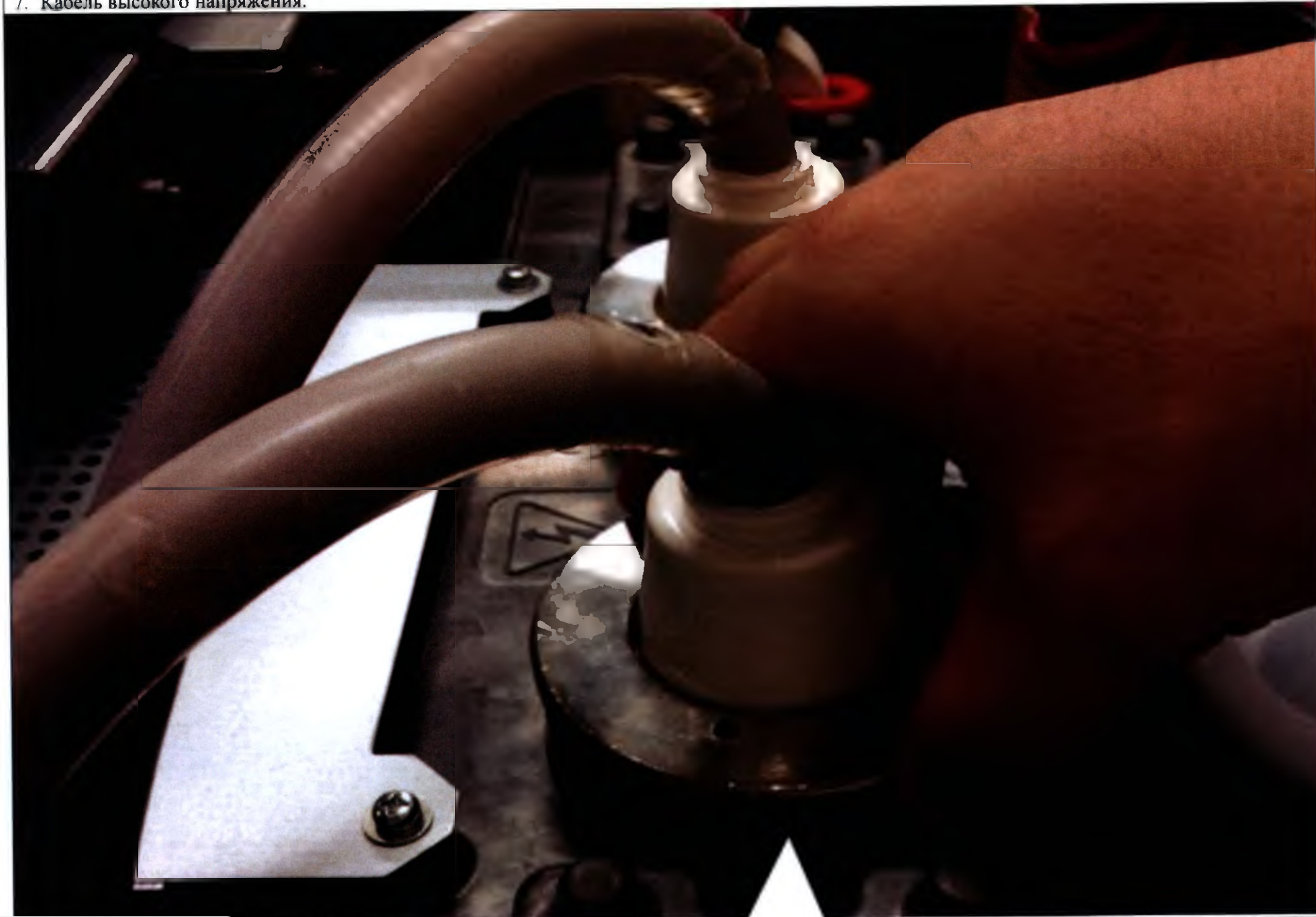
7. Кабель высокого напряжения.
