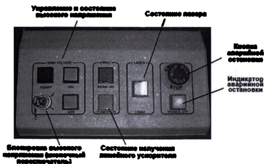
Рис. 2 Панель управления оператора
