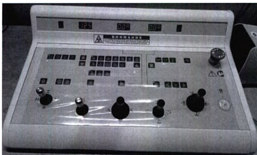
Рисунок 1.20 - Пульт управления. Расположение кнопки аварийного отключения.
