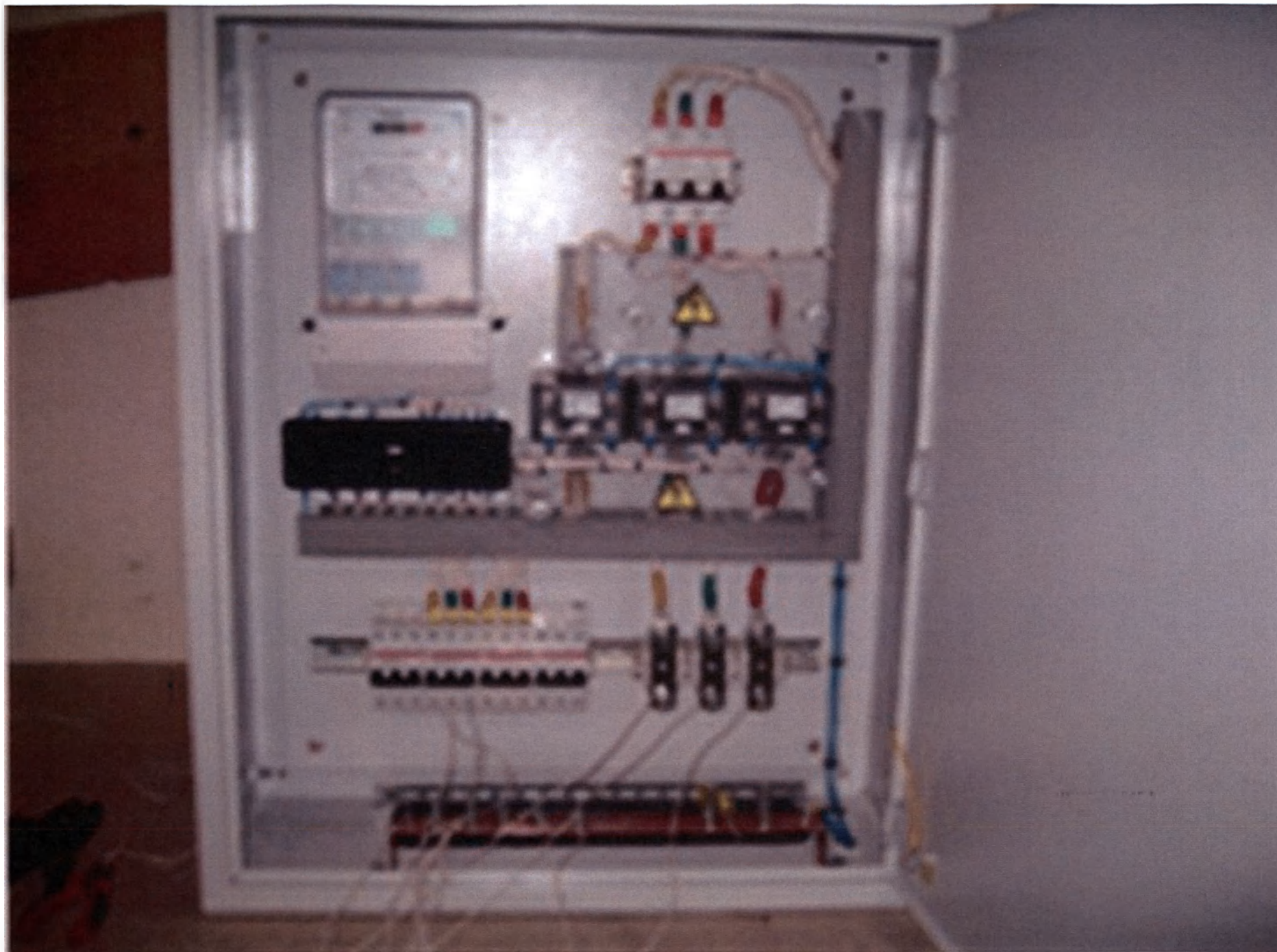
39. Распределительные щиты (от 1 до 3 штук).
