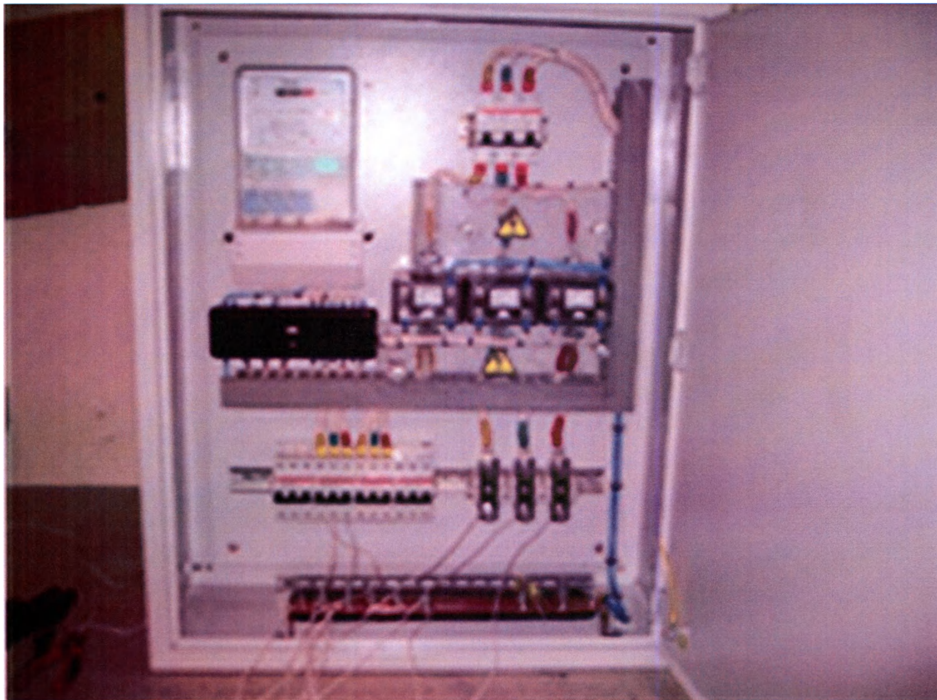
Распределительные щиты (от 1 до 3 штук)
