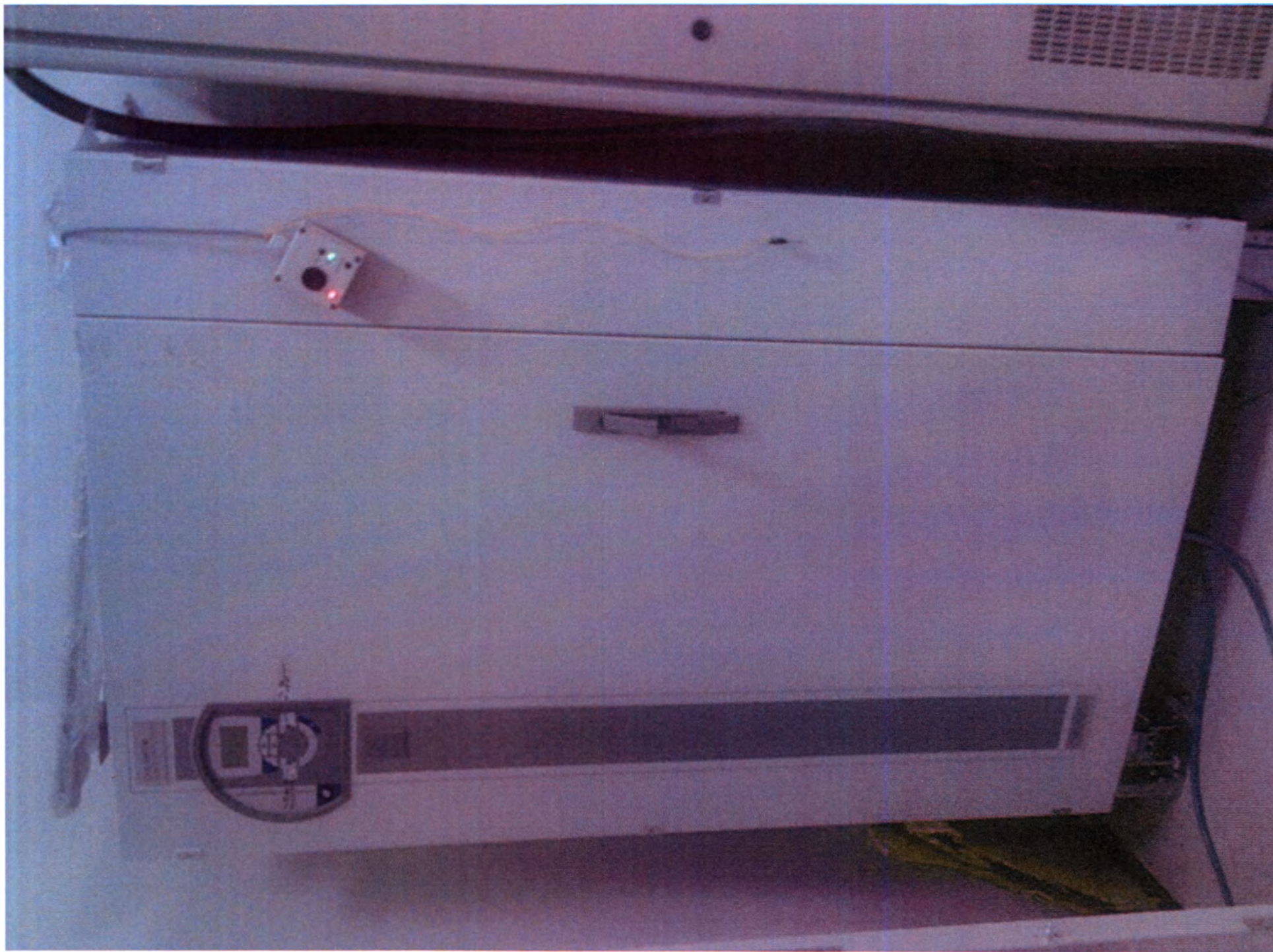
Источники бесперебойного питания (от 1 до 5 штук)
