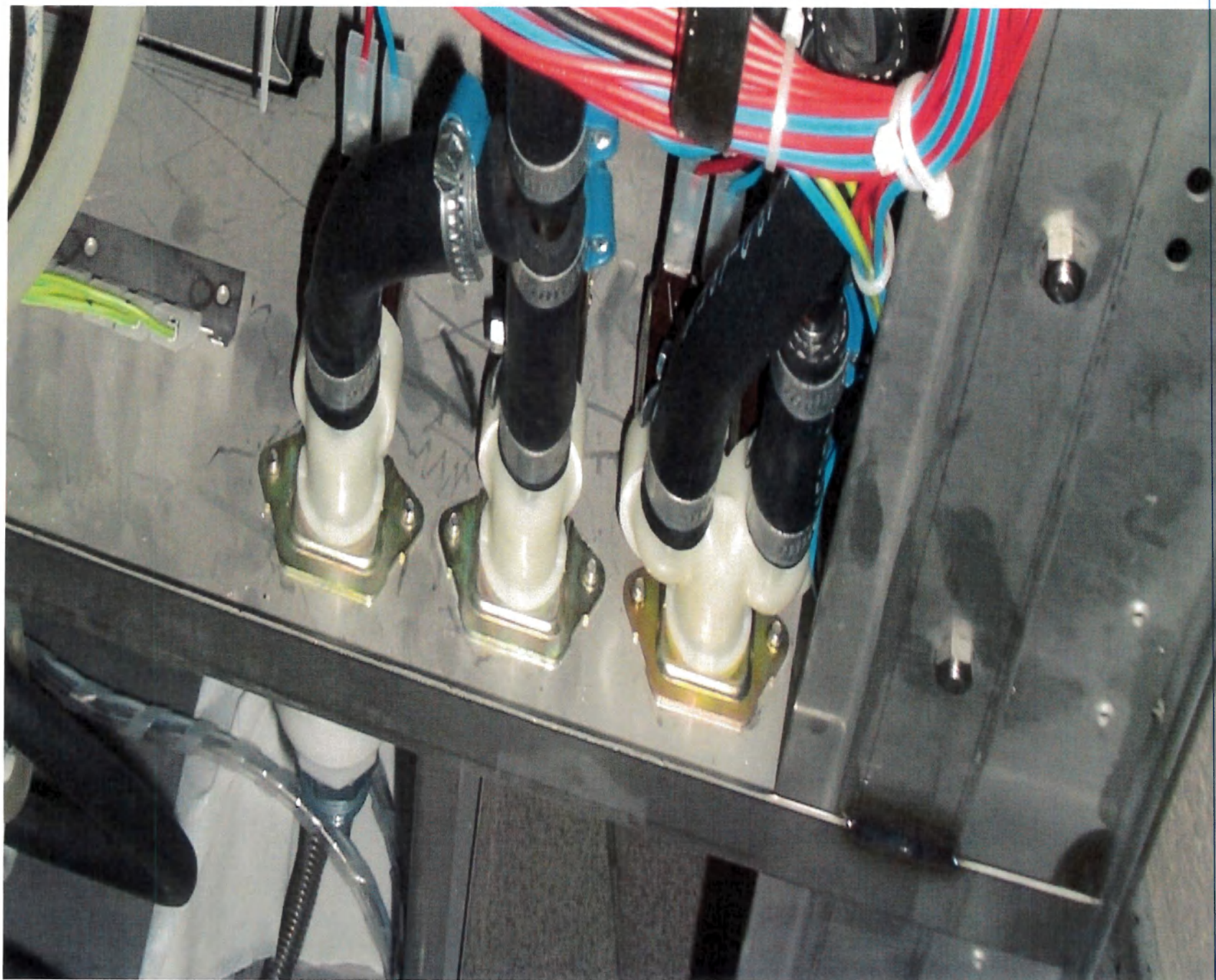
29. Подвод деминерализованной воды
