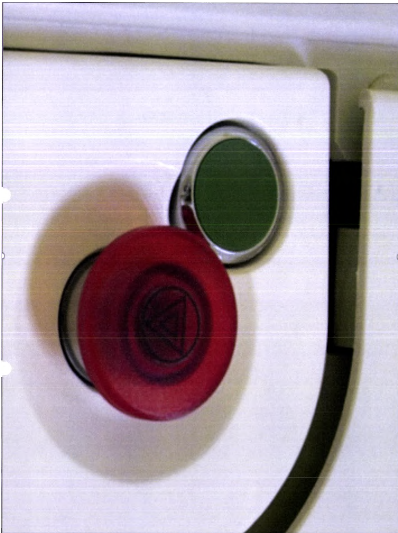
52. Рубильник аварийного выключения.
