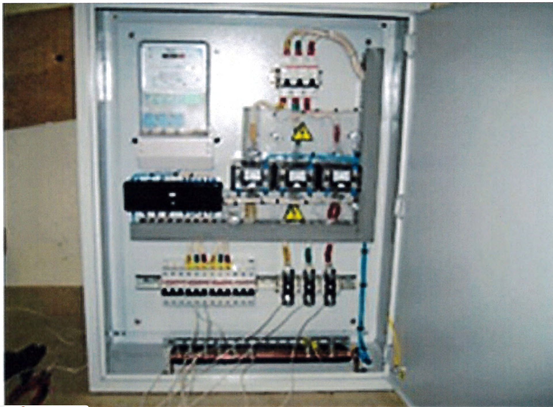
43. Распределительные щиты (от 1 до 5 штук).
