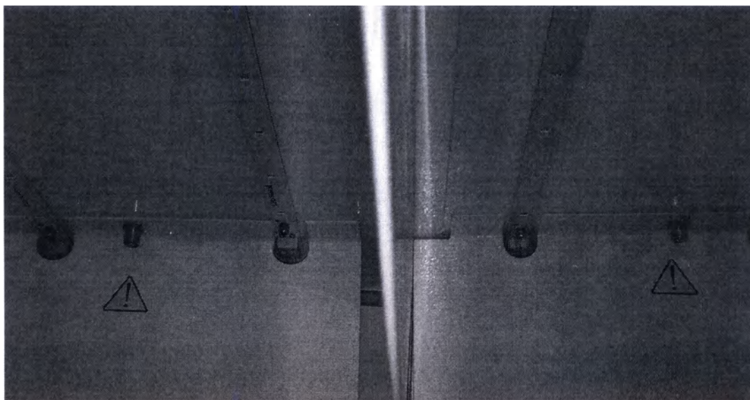
Защитный кожух с знаками опасности
